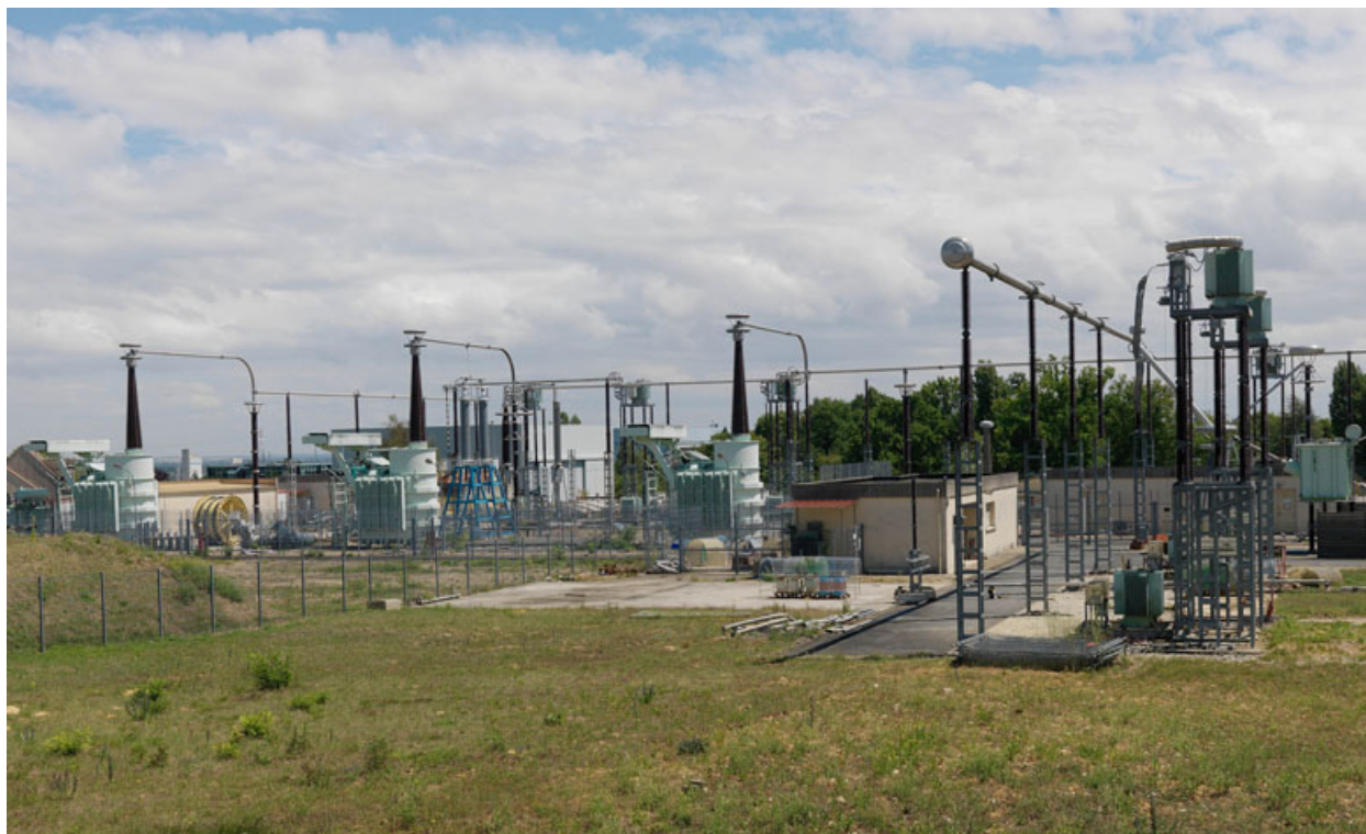
Installations électriques expérimentales.
