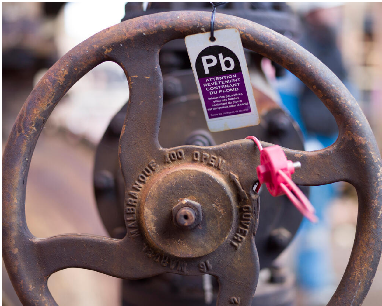
Unités Ouest - Zone de distillation (Unité 612). Volant d'un robinet manuel permettant de réguler un débit (tout produit).
