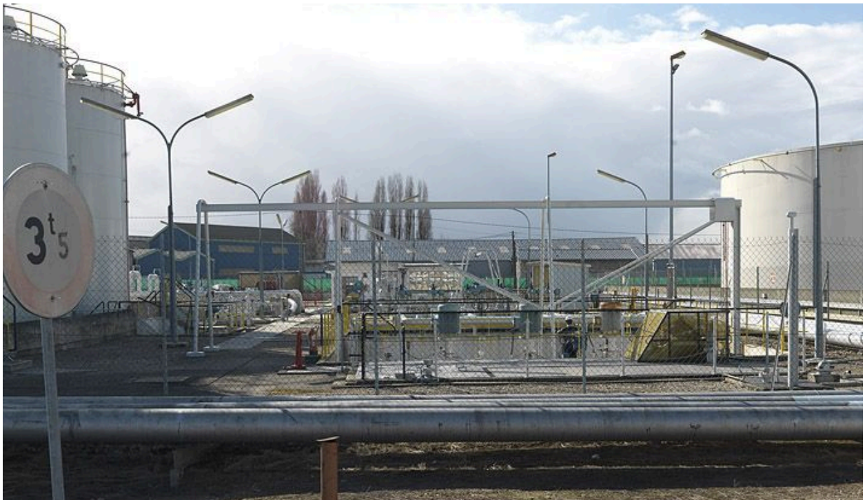
Villeneuve-le-Roi, dépôt pétrolier. Vue des installations permettant de remplir les cuves depuis les pipelines d'alimentation.
