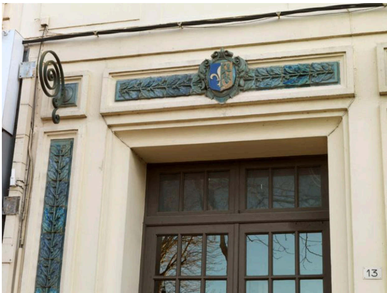
Vue de détail de l'entrée : ferronnerie de l'ancienne marquise et céramique vernissée.
