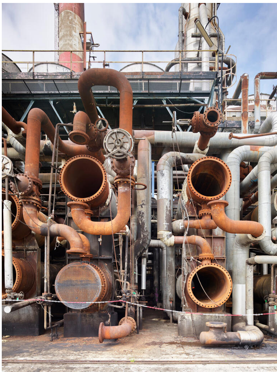
Unités Ouest. Détail des trains d'échange de l'unité 612 de distillation atmosphérique/ sous-vide.
