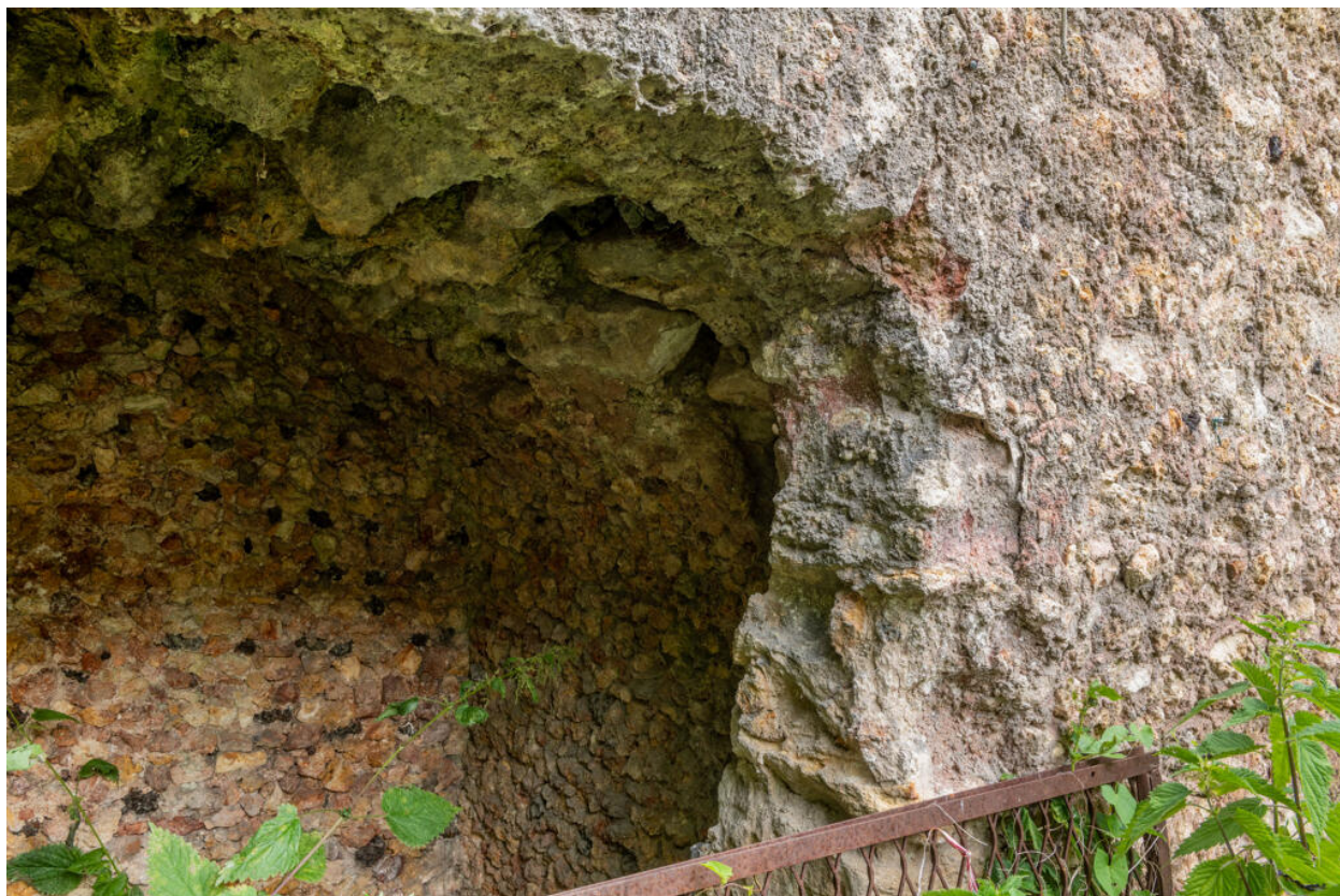
Détail du rocaillage dans la niche de l'escalier en fer à cheval.
