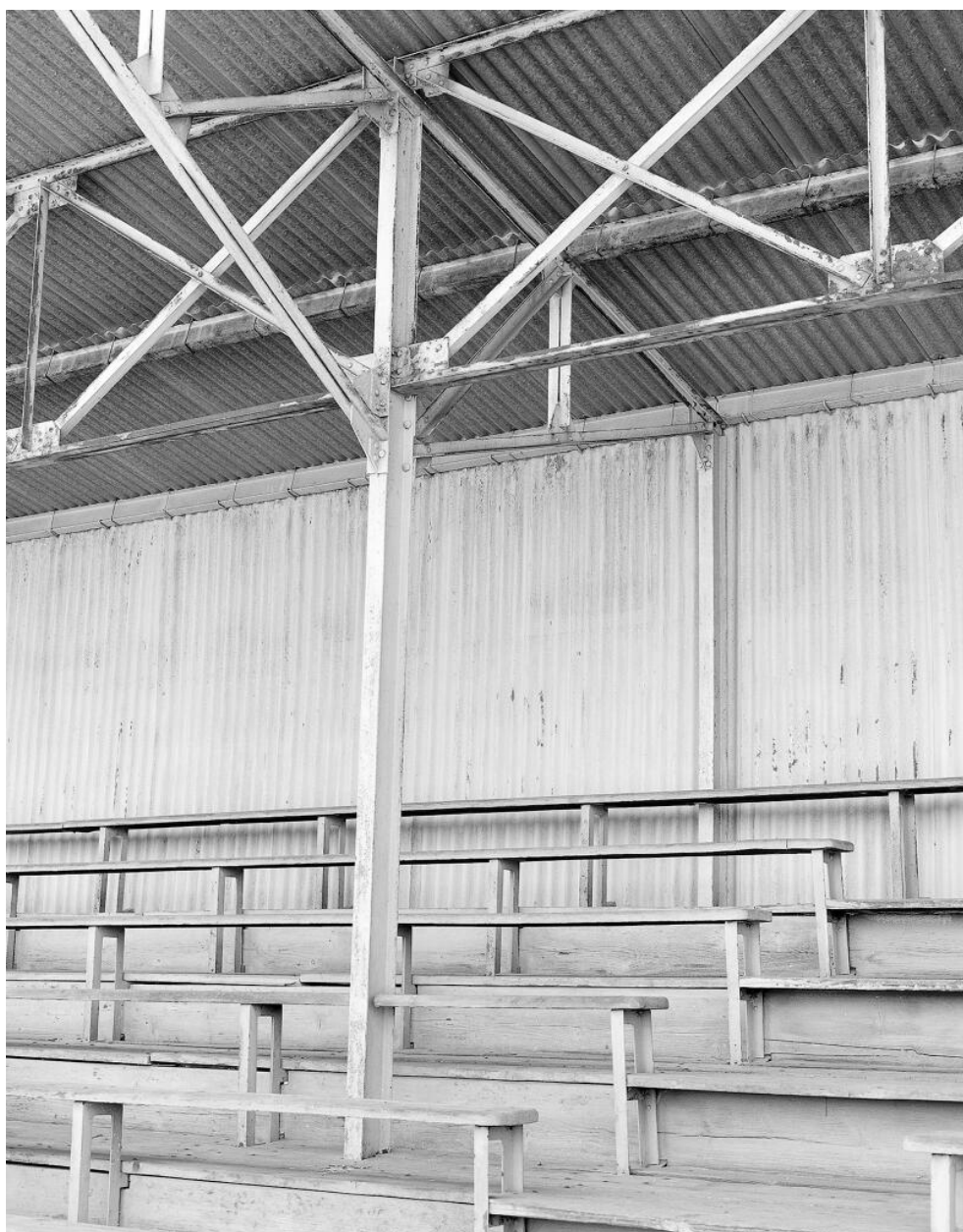
Détail des gradins en bois et de la charpente métallique des tribunes. Stade Jack-Baudequin
