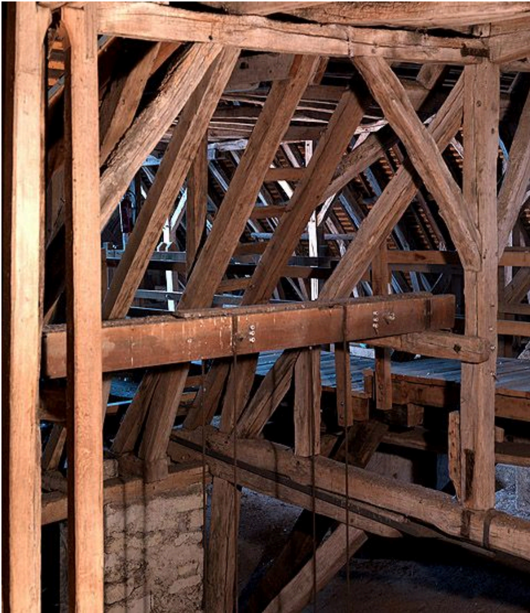
Détail de la charpente : travée à l'angle du choeur et du transept.
