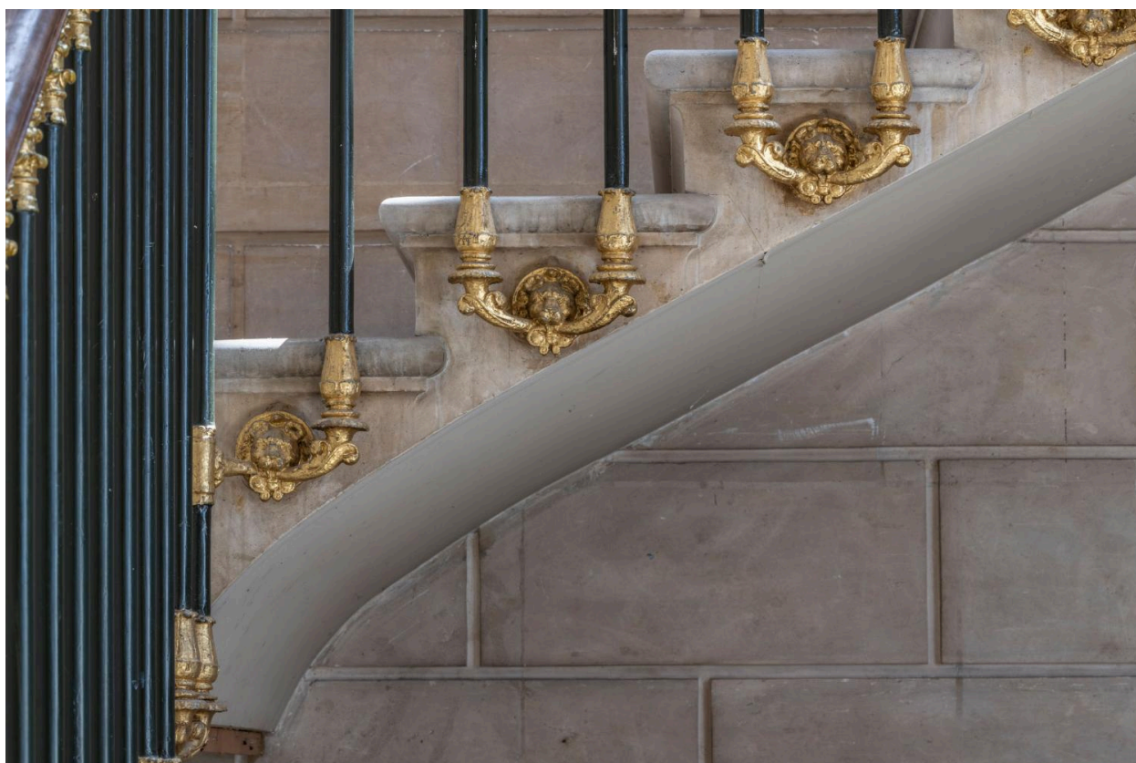
Détail de l'escalier d'honneur, barreaux retenus deux à deux par des équerres en bronze doré.
