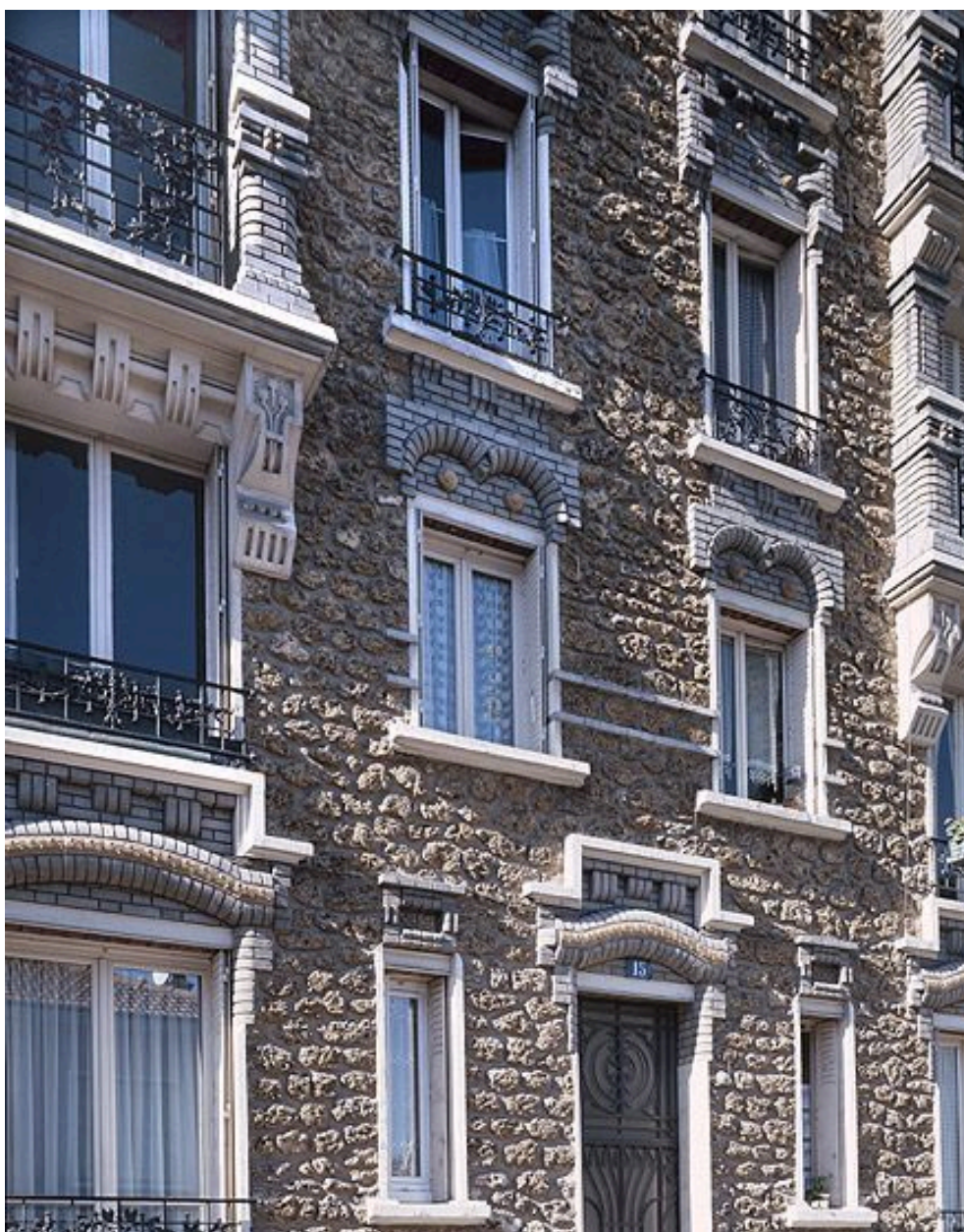
Immeuble, 15 rue Guy Moquet. Vue de la partie basse de la façade.
