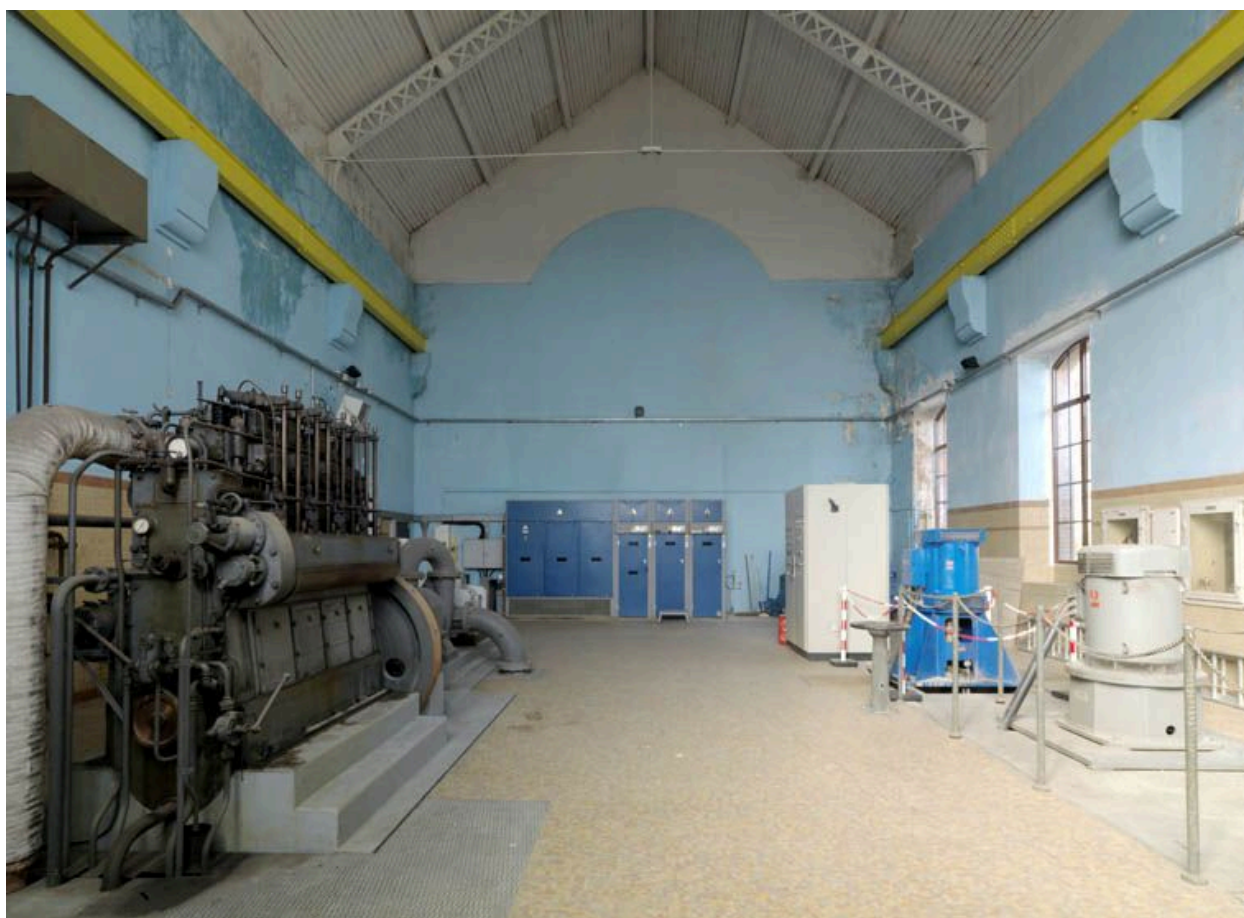
Bâtiment des pompes, salle des machines.
