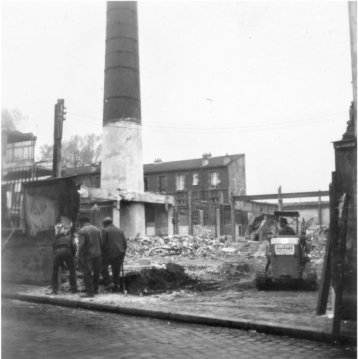
Destruction de la chaufferie de l'usine Kalker, 1968 (coll. Jean Huret).
