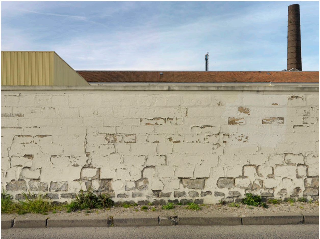
Persan. Ancienne usine de caoutchouc "The India Rubber", actuellement usine Hutchinson. Mur d'enceinte.
