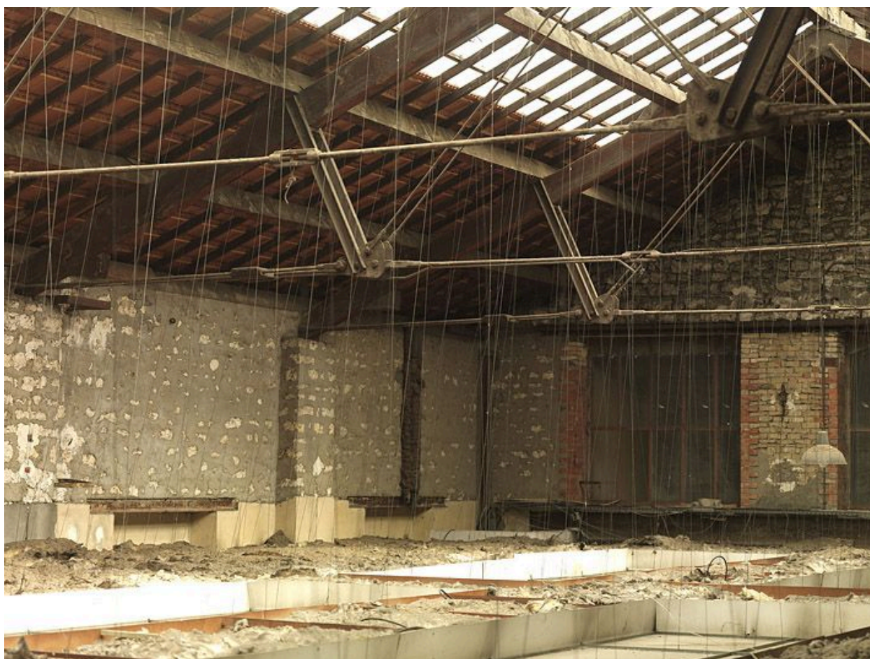
Charpente Polonceau de l'ancienne remise de voitures de la Compagnie des Tramways de Fontainebleau, depuis le nord.
