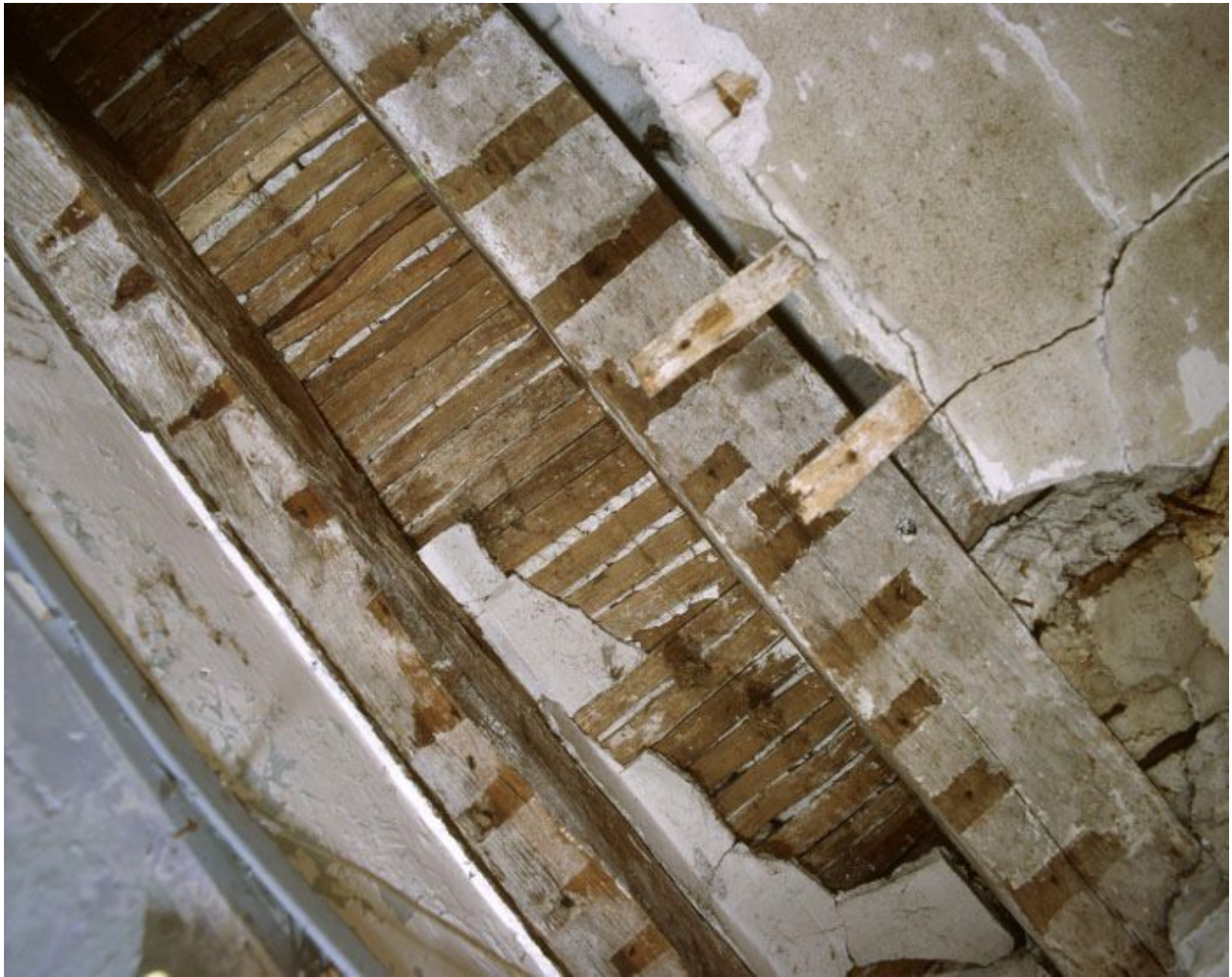
Lattis en mauvais état du plafond de la seconde pièce de l'ancienne habitation.
