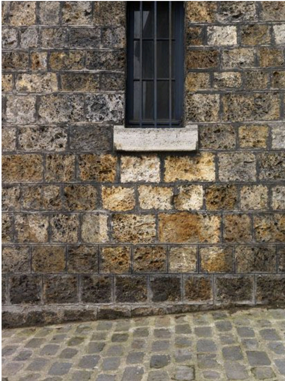
92, Sceaux, lycée Lakanal, 3-7 avenue du Président-Franklin-Roosevelt. Cour des cuisines : soubassement d'un mur d'un réfectoire.
