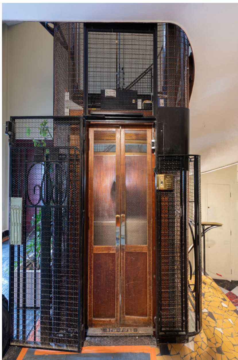
Immeuble, cabine d'ascenseur
