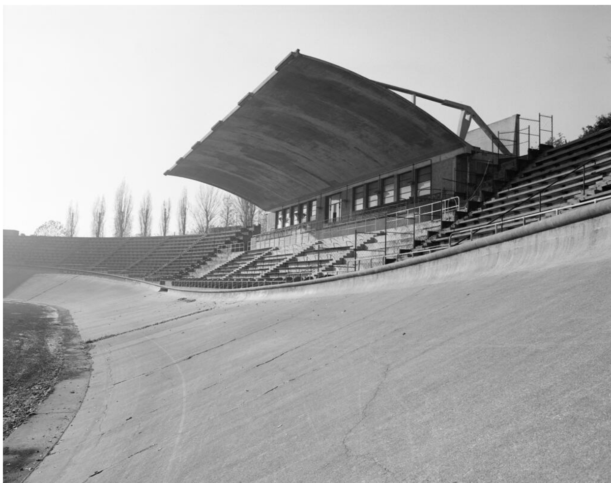
Tribune de la piste d'athlétisme, montrant la structure de l'auvent. Complexe sportif dit stade de la croix de Berny ou Union Sportive Métropolitaine des Transports
