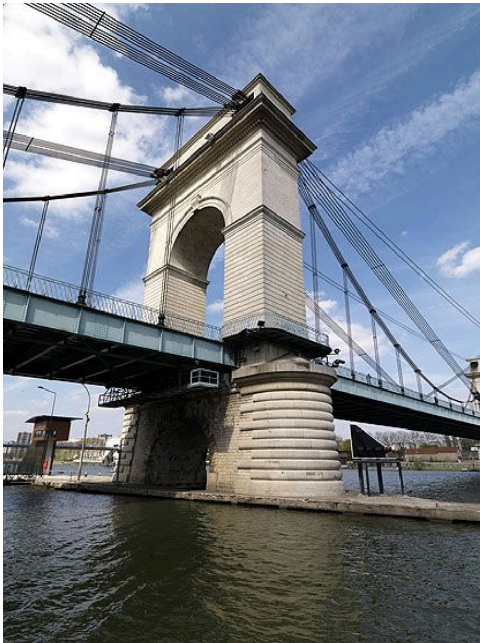
Vitry-sur-Seine, Alfortville. Pont de Port-à-l'Anglais. Vue d'ensemble de la pile côté Vitry.
