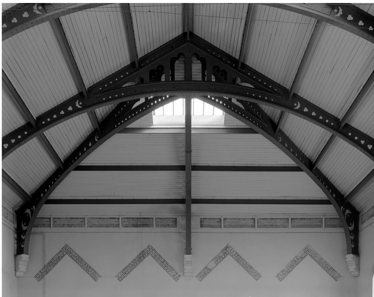
Gymnase : Détail de charpente de la dernière travée vue depuis le côté de l'entrée. Lycée dit Lycée Lakanal
