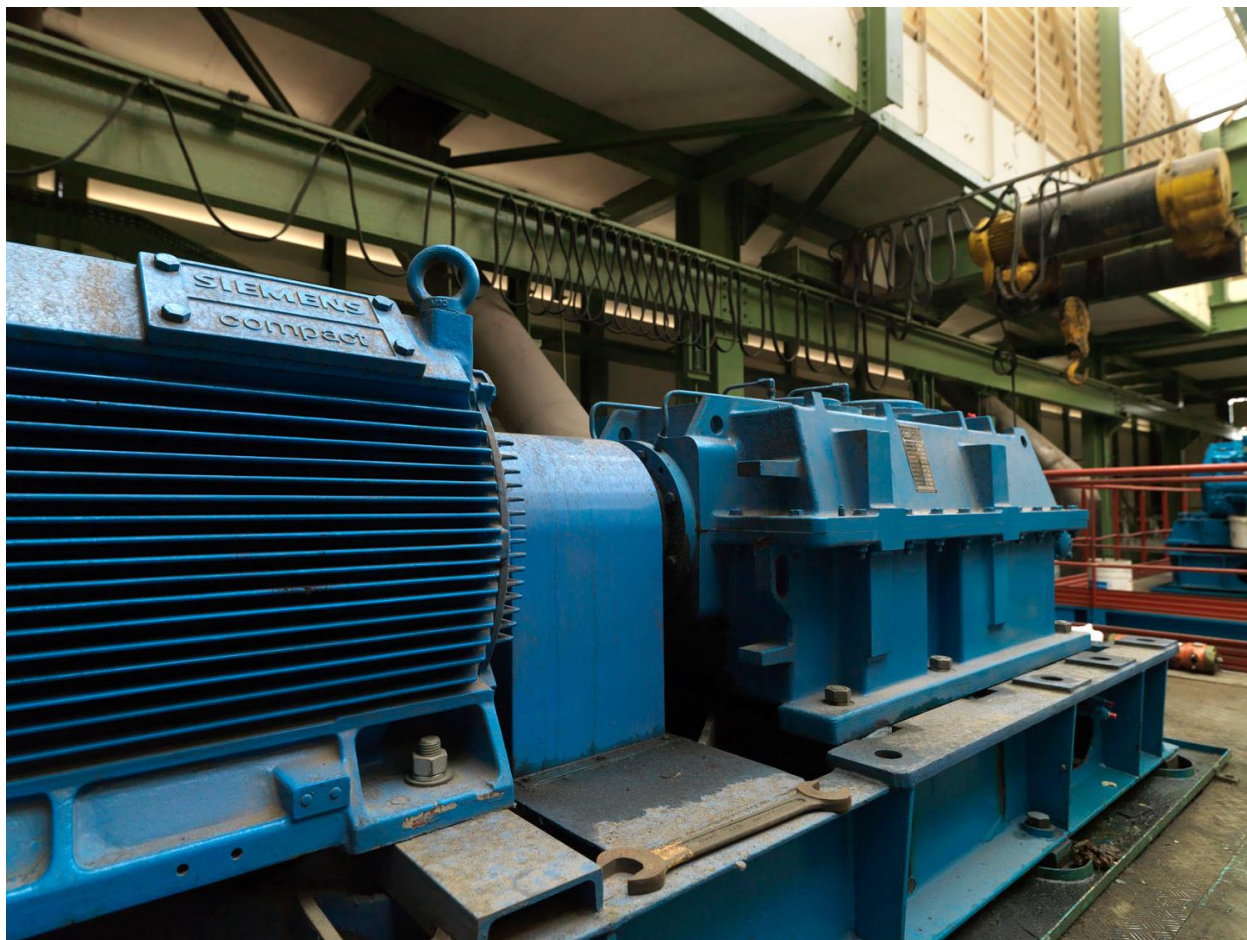
Site Sanofi. Bâtiment de transformation. Cuves.
