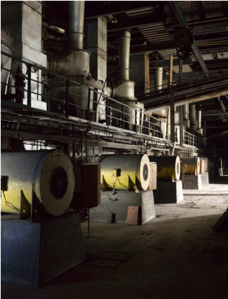
Générateur de vapeur groupe 125MW. Broyeur
