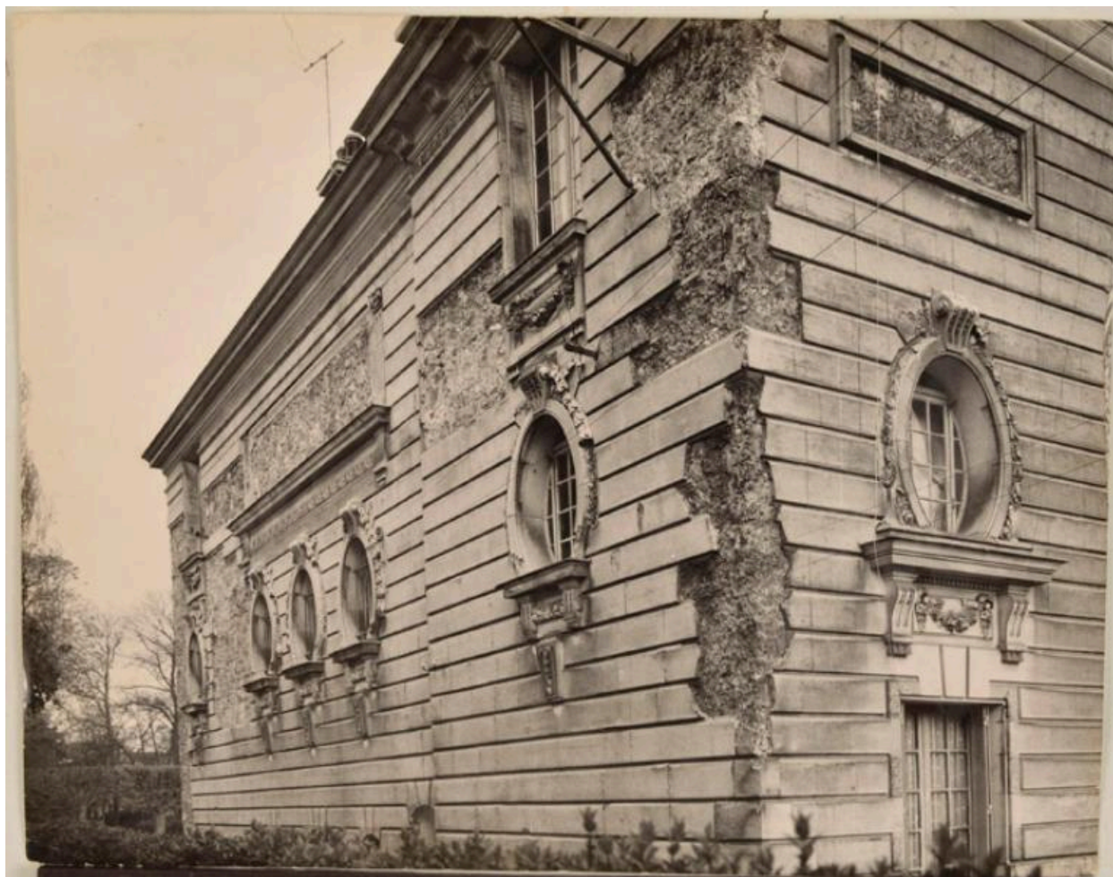
État de la façade latérale avant restauration. (AM Mantes-la-Jolie 2 Fi 35)
