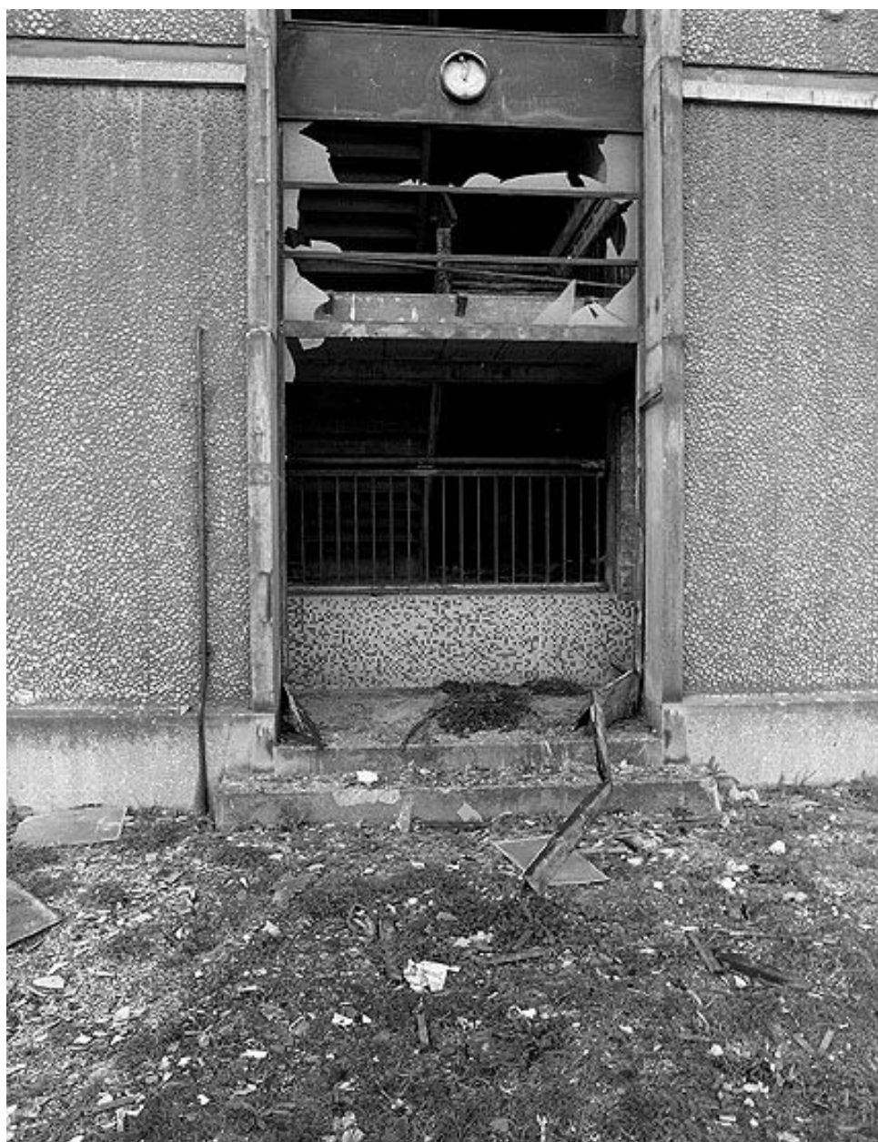
Tour 5 - Cage d'escalier façade sud. Campagne photographique, lors de la destruction du bâtiment en 1976.
