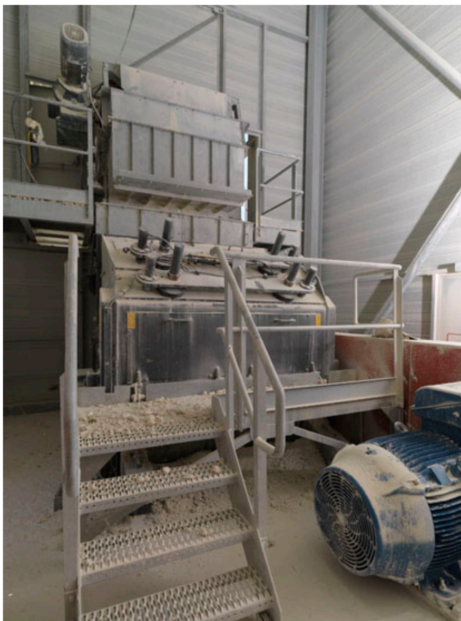
Plateforme - installation secondaire.
