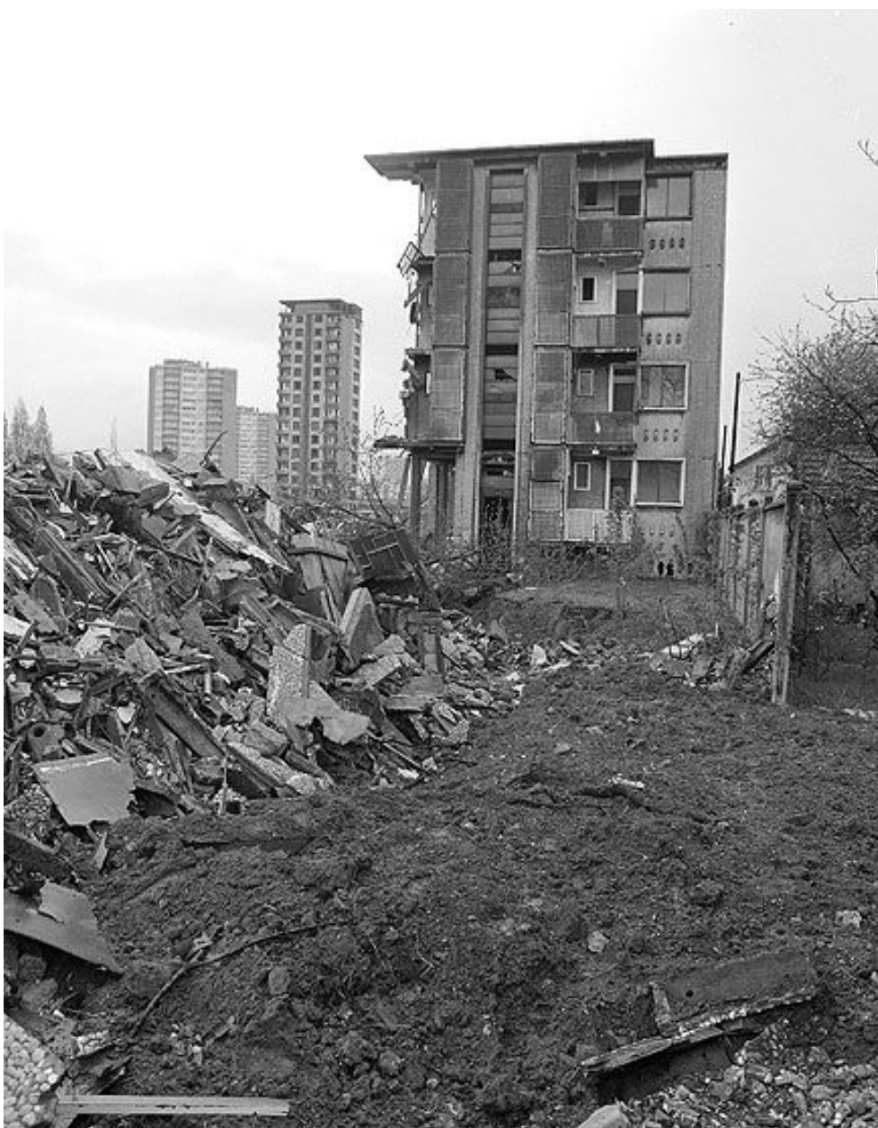
Peigne 4, façade ouest. Campagne photographique, lors de la destruction du bâtiment en 1976.
