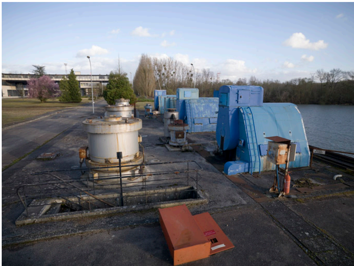
Stations de pompage.
