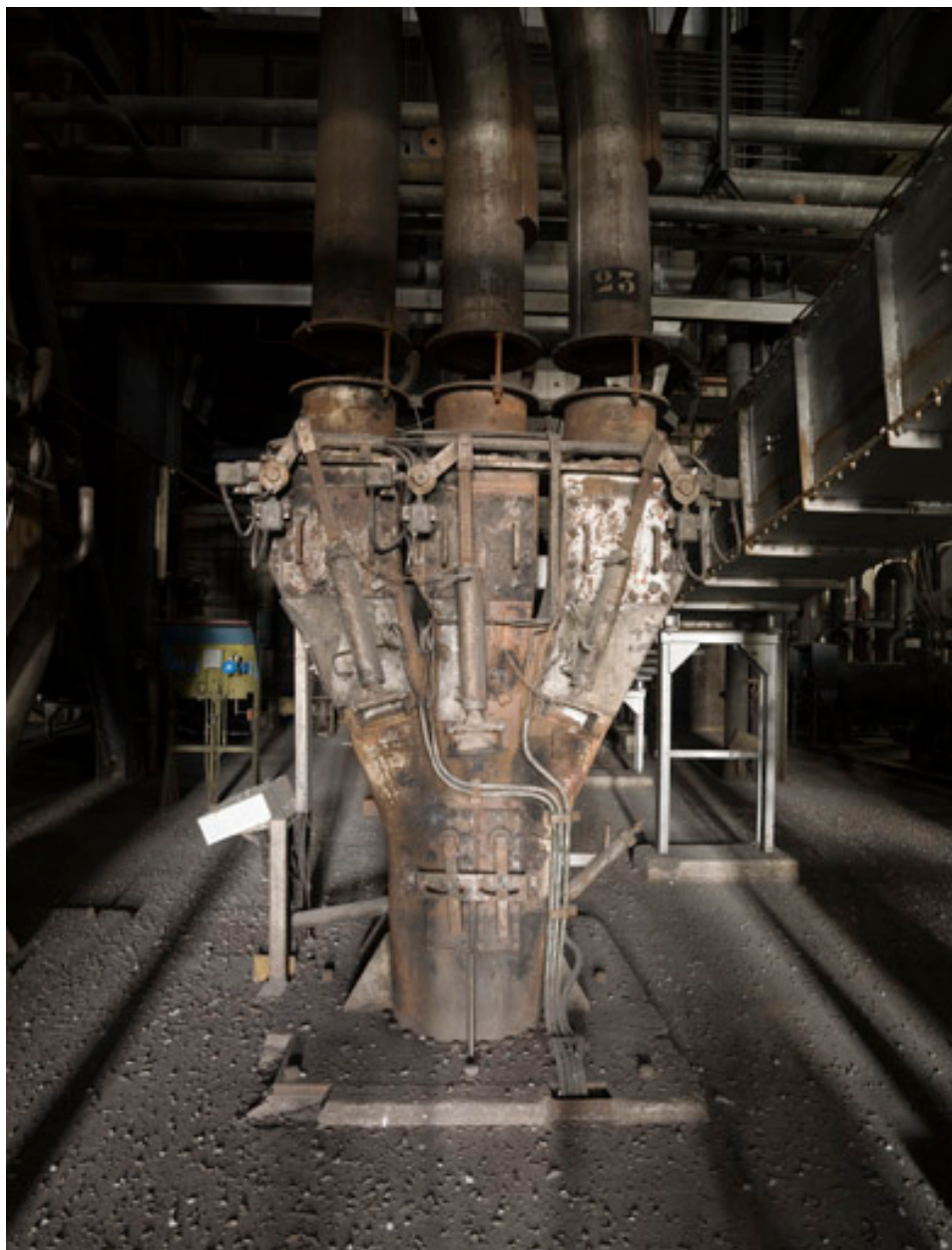
Générateur de vapeur groupe 125MW. Broyeur
