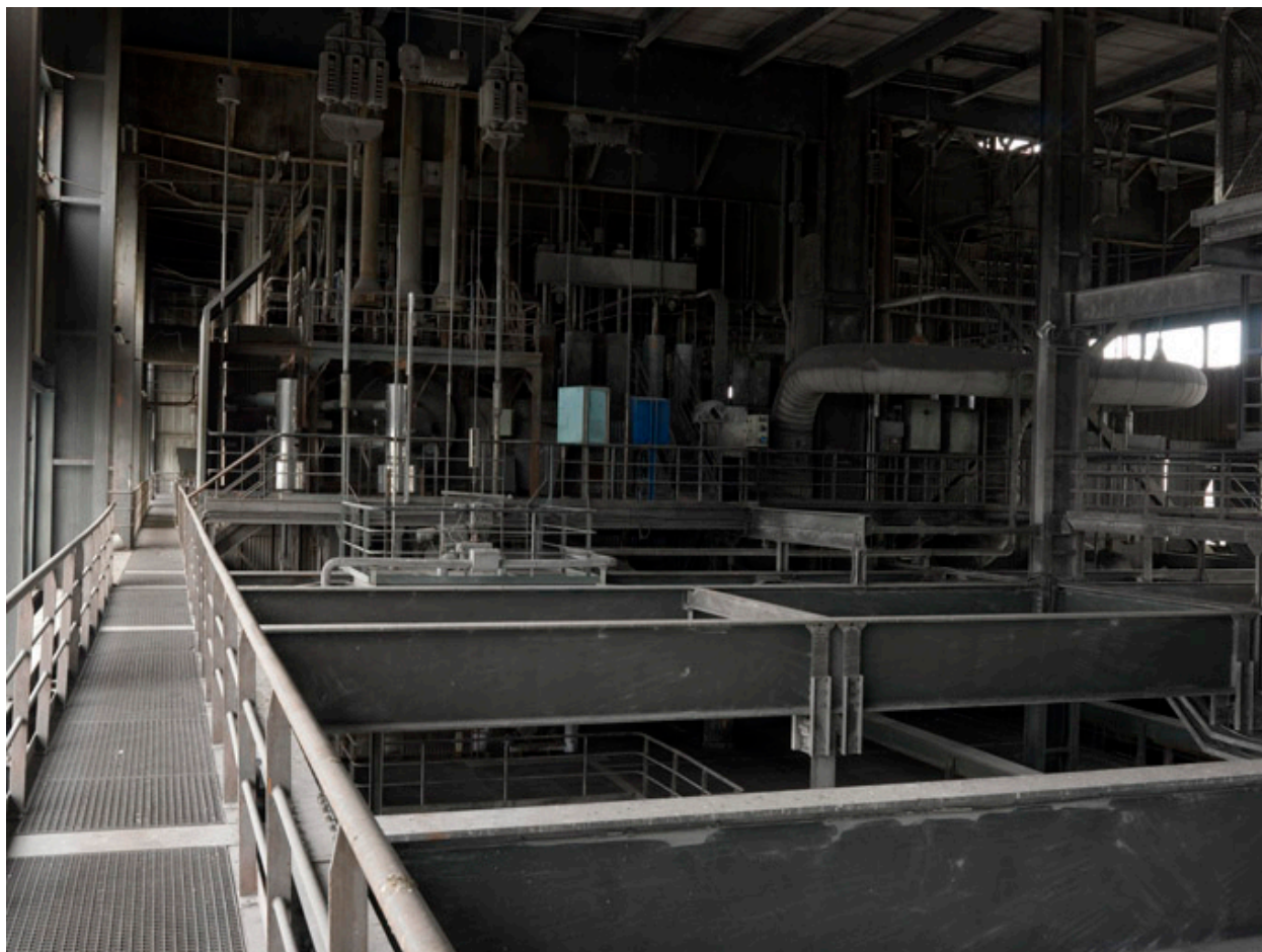
Générateur de vapeur 250 MW. Chaudiere
