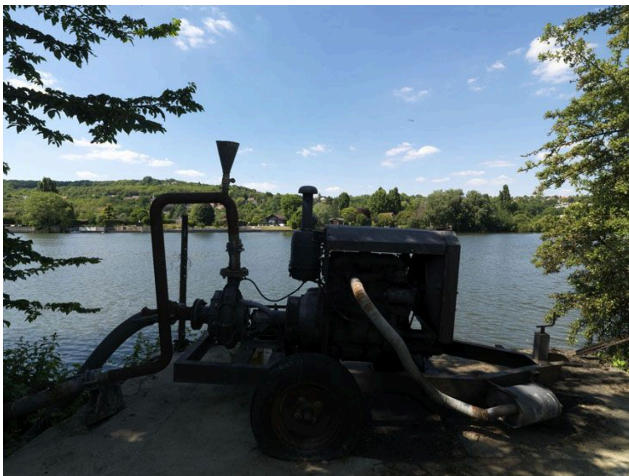
Les Mureaux : pompe agricole en face de l'île de Mézy.
