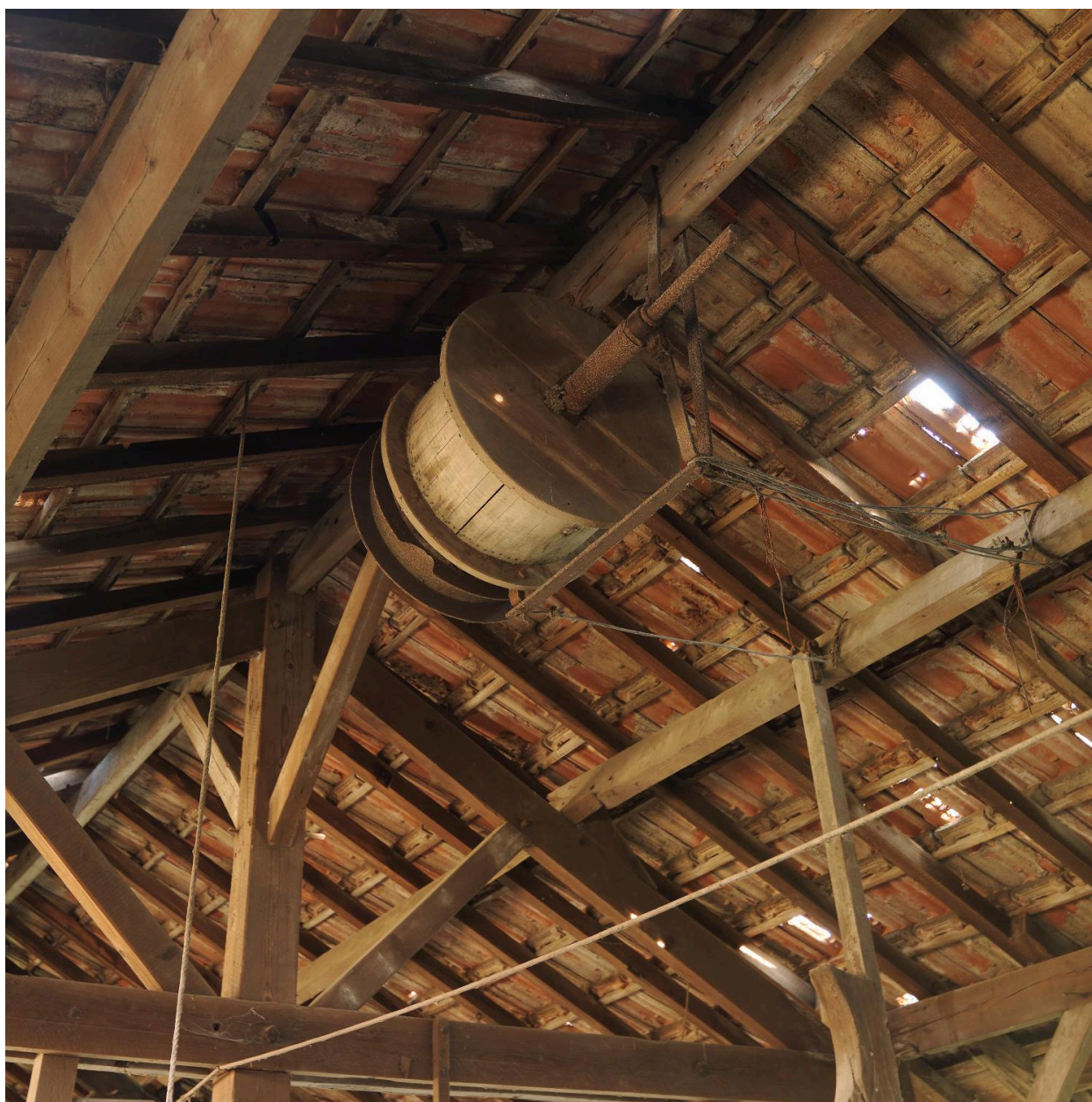
Installations pour le câblage des cordes, poulie.
