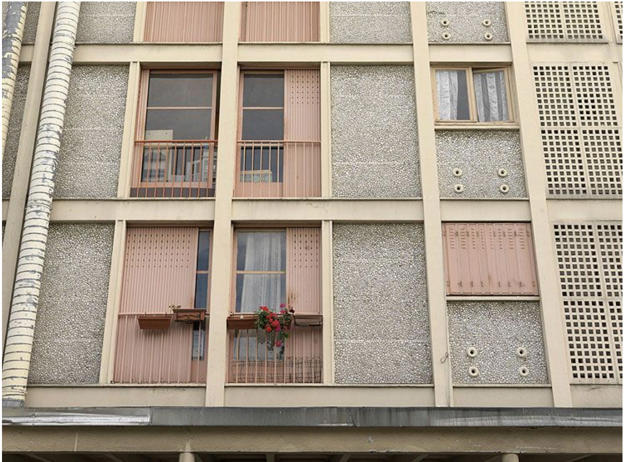
Détail de la façade avant travaux, avec les huisseries de J. Prouvé encore en place.
