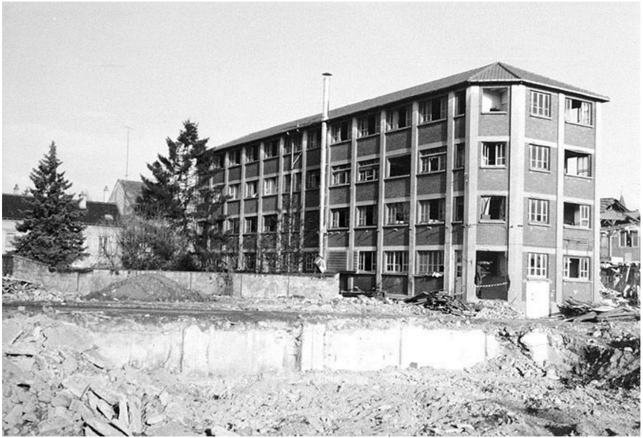
L'usine Vernin en cours de démolition, vue du nord. Photographie. (Collection particulière (M. Bouvet, à Melun))
