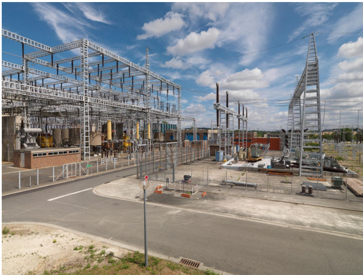
Charpente électrique extérieure.
