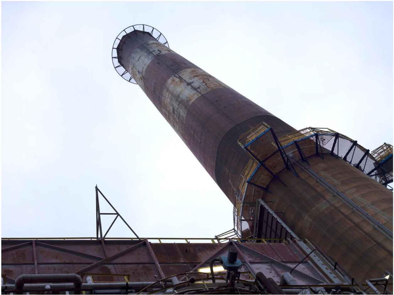
Unités Ouest - Zone de distillation (Unité 612). Cheminée du four 612 F1.
