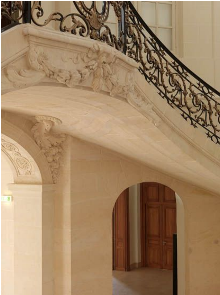
Détail des sculptures ornant la voûte.
