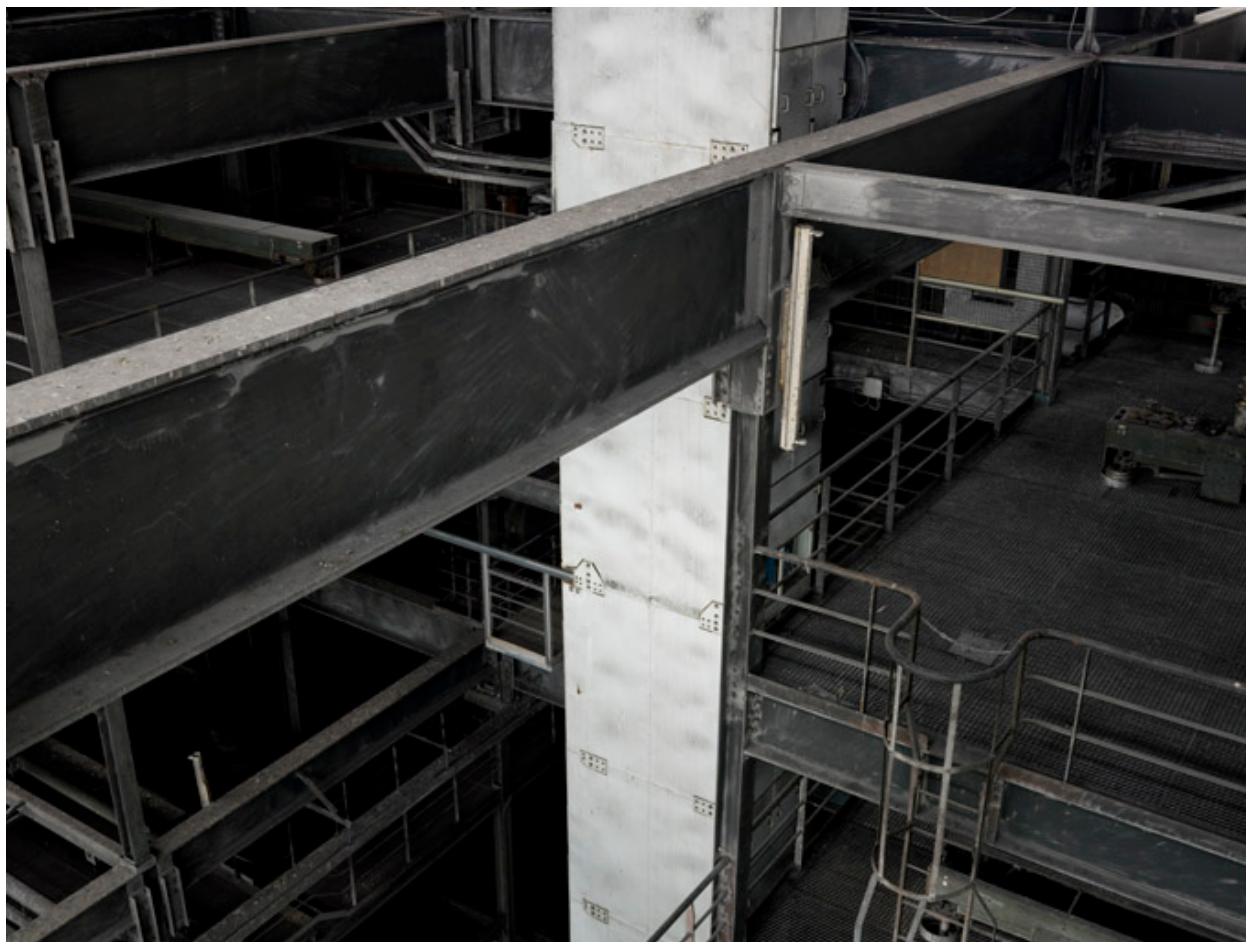
Générateur de vapeur 250 MW. Structure métallique.
