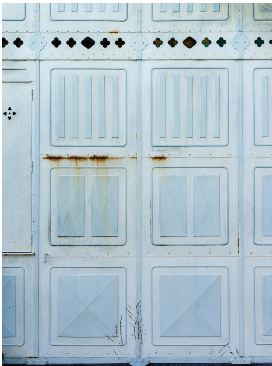
Panneaux en façade latérale.
