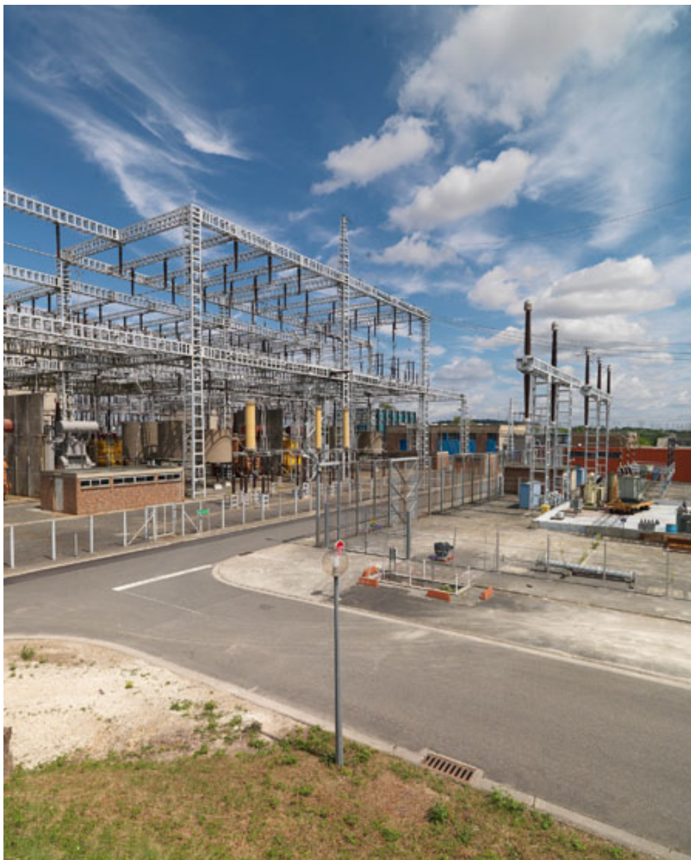
Charpente électrique extérieure.
