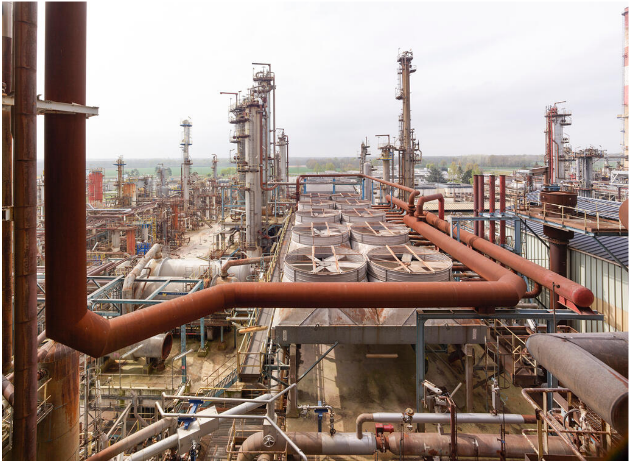
Unités Est - Zone FCC (Unité 651). Vue sur la partie supérieure des aéroréfrigérants E 1001 depuis la zone réactionnelle du FCC.
