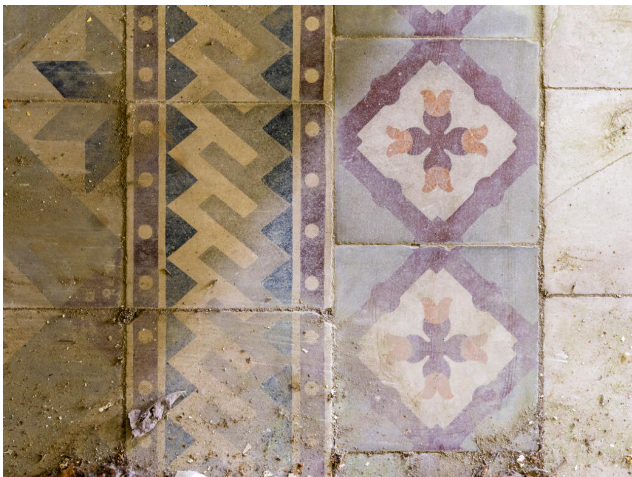
Maison d'Octave Allaire, carreaux de ciments du sol des pièces du rez-de-chaussée à décor de frises géométrique et florale
