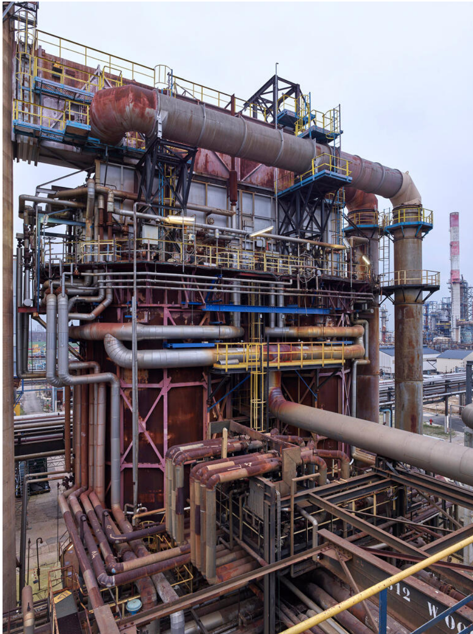
Unités Ouest - Zone de distillation (Unité 612). Vue de la partie haute du four 612 F1 depuis l'intérieur des Unités.
