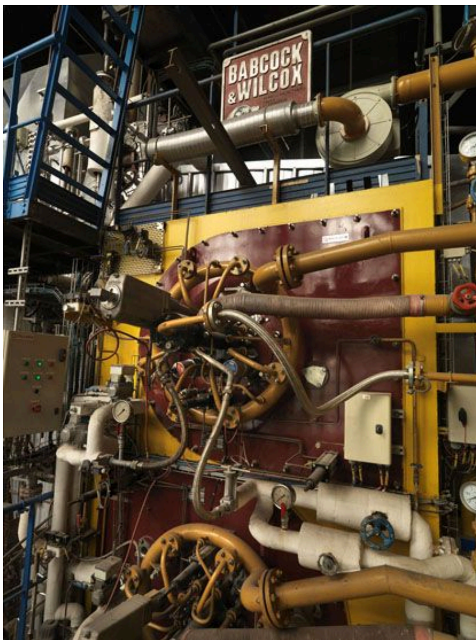
Site Sanofi. Plaque Bacock et Wilcox, bâtiment de la chaufferie.
