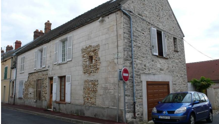
Maison de bourg dénaturée située au 15, rue de la Cité : une porte de garage a été aménagée dans le pignon du bâtiment et des baies ont été comblées dans la façade sur rue.
