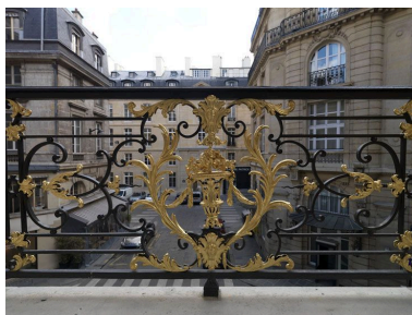
Détail du balcon : un panier fleuri, motif qu'on retrouve aussi dans la fenêtre centrale. Phot. Philippe Ayrault IVR11_20107500269NUC4A
