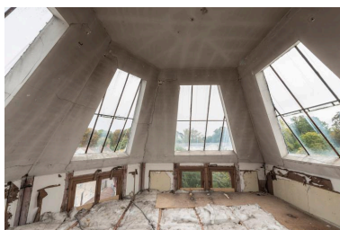
Intérieur de l'atelier Phot. Laurent Kruszyk IVR11_20199100441NUC4A
