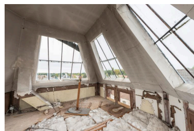
Intérieur de l'atelier Phot. Laurent Kruszyk IVR11_20199100442NUC4A
