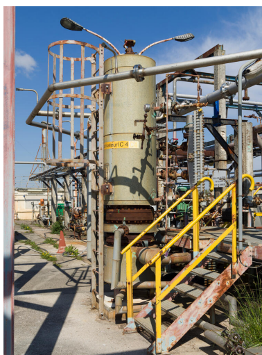
Zone de chargement GPL (Unité 550). Poste de déchargement GPL. Ballon vaporisateur IC4 utilisé lors des déchargements des wagons d'IC4 (isobutane). Phot. Stéphane Asseline, Phot. Stéphane Asseline IVR11_20237700353NUC4A
