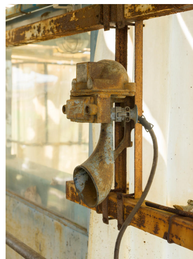
Chargement poste fer (Unité 540). Ancien avertisseur sonore : il s'agit d'avertir d'un treuillage des wagons en cours. Phot. Stéphane Asseline, Phot. Stéphane Asseline IVR11_20237700372NUC4A
