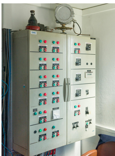
Zone de chargement GPL (Unité 550). Local poste de chargement GPL. Pupitre de commandes des pompes expéditions GPL. Phot. Stéphane Asseline, Phot. Stéphane Asseline IVR11_20237700356NUC4A
