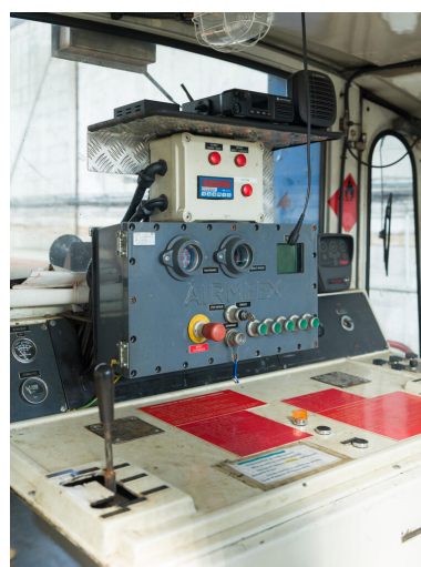
Local des locotracteurs. Locotracteur 12-69. Poste de pilotage. Phot. Stéphane Asseline, Phot. Stéphane Asseline
