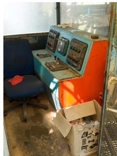
Chargement poste fer (Unité 540). Pupitre extérieur de commande poste fer, permettant le pilotage en direct de la canne de chargement. Phot. Stéphane Asseline, Phot. Stéphane Asseline IVR11_20237700369NUC4A
