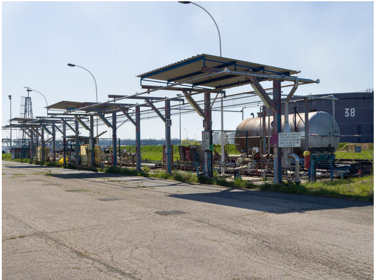
Zone de chargement GPL (Unité 550). Quai de chargement GPL. À l'arrière, ballon de méthanol, servant d'antigel, injecté dans le butane en hiver au moment du chargement dans les camions.
