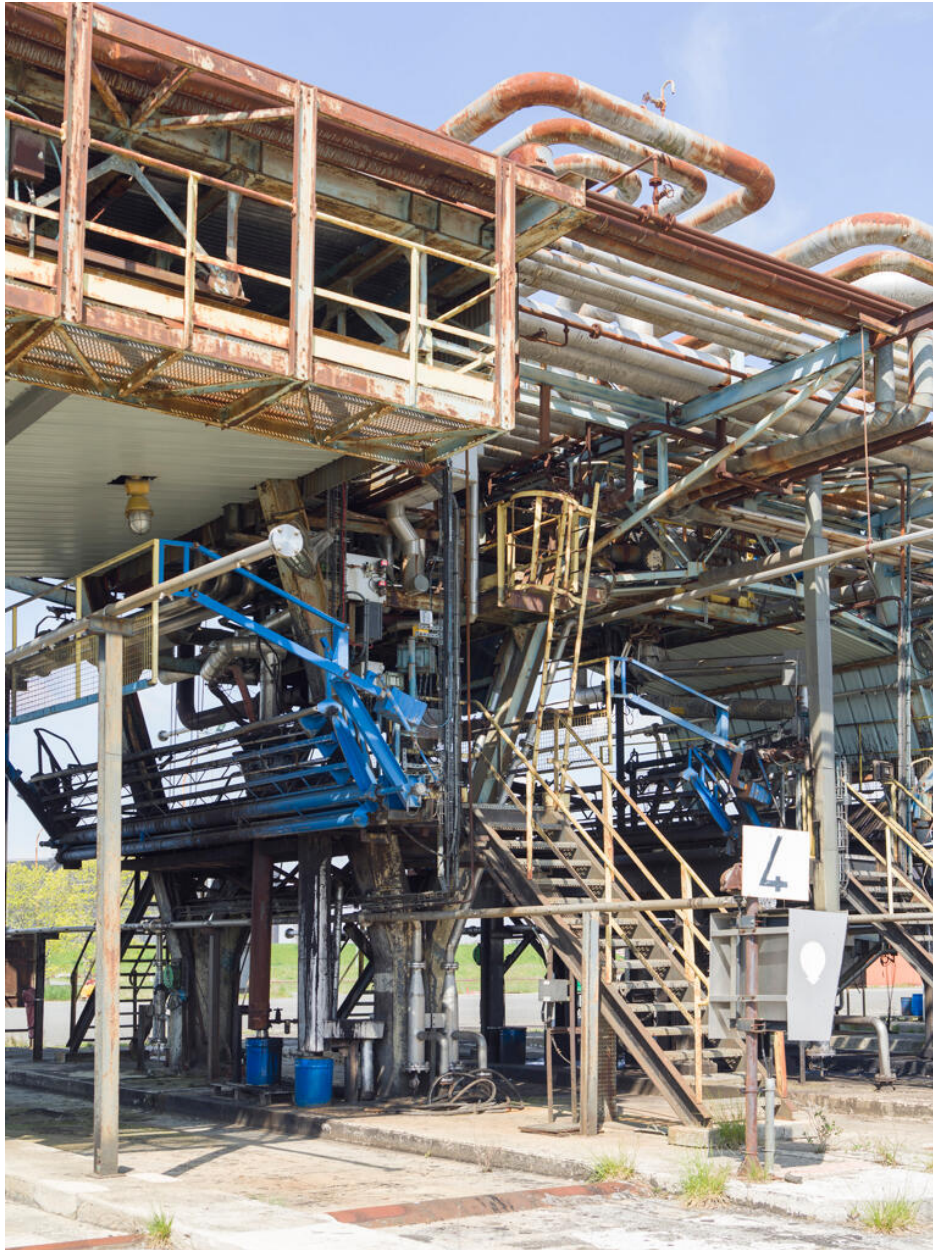
Quais de chargement route multiproduits (Unité 530). Passerelles de chargement en dôme (par le toit), dispositif réservé aux produits lourds (normes de sécurité).
