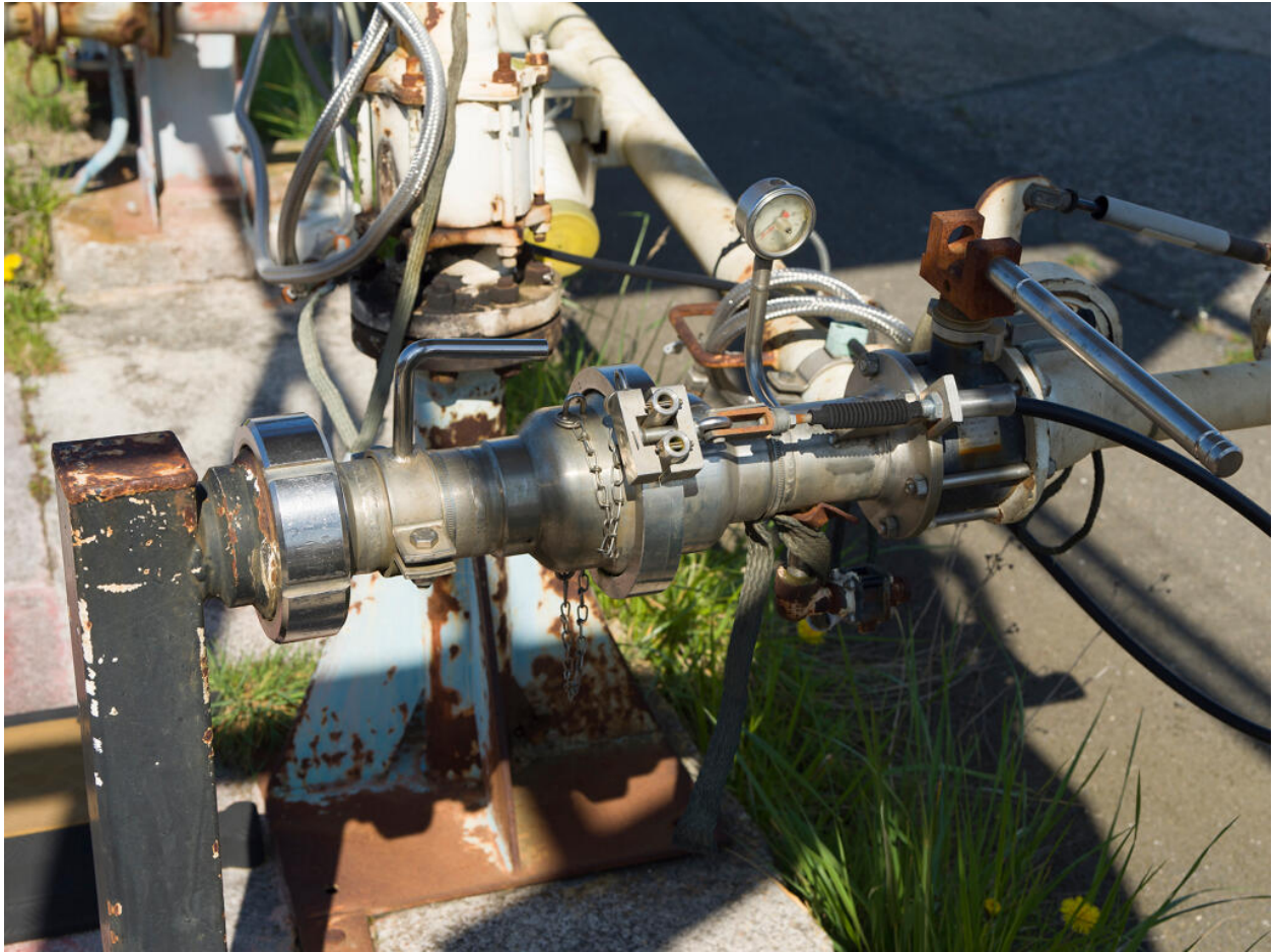
Zone de chargement GPL (Unité 550). Quai de chargement GPL. Bras de chargement GPL avec son organe de sécurité (clapet anti-arrachement "ERS").
