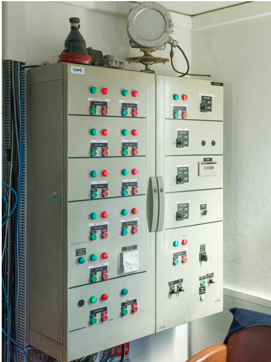
Zone de chargement GPL (Unité 550). Local poste de chargement GPL. Pupitre de commandes des pompes expéditions GPL.
