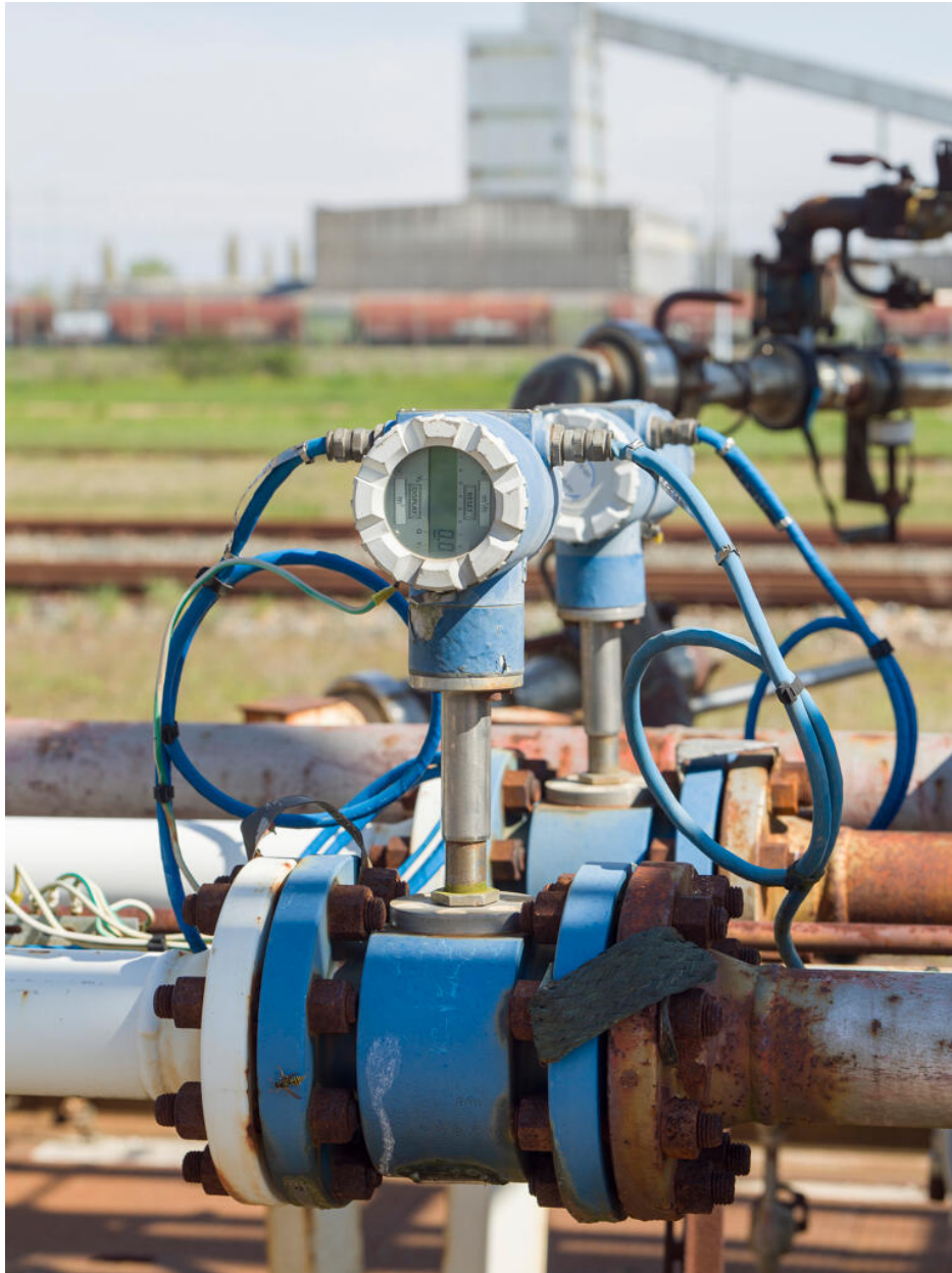
Zone de chargement GPL (Unité 550). Poste de déchargement GPL. Débitmètre.
