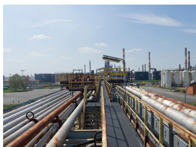
Quais de chargement route multiproduits (Unité 530). Quais de chargement route multiproduits. Passerelle d'accès au rack quai de chargement route. Accès par le haut vers le bas aux vannes d'ouverture, situées au-dessus des quais de chargement. Phot. Stéphane Asseline, Phot. Stéphane Asseline IVR11_20237700364NUC4A
