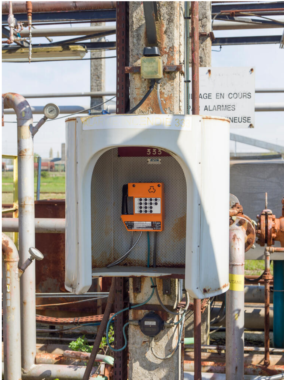
Zone de chargement GPL (Unité 550). Quai de chargement GPL. Généphone ("nouvelle génération") utilisé pour communiquer avec la salle de contrôle sur les opérations en cours, et éventuellement prévenir les secours.
