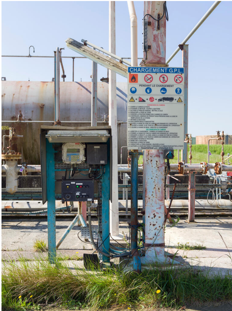
Zone de chargement GPL (Unité 550). Quai de chargement GPL. Le panneau à droite indique le mode opératoire du chargement. À gauche, le compteur volumétrique.
