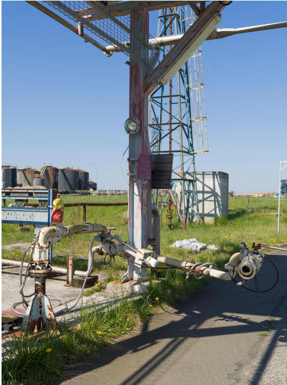
Zone de chargement GPL (Unité 550). Quai de chargement GPL. Bras de chargement GPL déplié, prêt à être connecté à un camion. Lance Molitor, organe de sécurité incendie.
