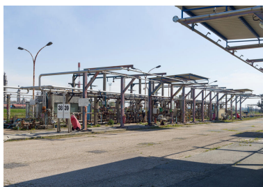
Zone de chargement GPL (Unité 550). Quai de chargement GPL. Phot. Stéphane Asseline, Phot. Stéphane Asseline IVR11_20237700344NUC4A
