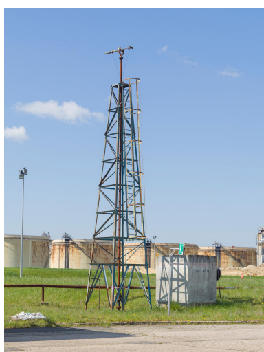
Zone de chargement GPL (Unité 550). Poste de déchargement GPL. Lance Molitor, organe de sécurité incendie. Sa hauteur permet d'améliorer son champ d'action. Elle est actionnée manuellement depuis le sol, via des câbles. Phot. Stéphane Asseline, Phot. Stéphane Asseline IVR11_20237700355NUC4A
