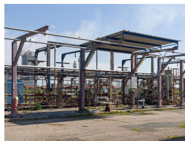
Zone de chargement GPL (Unité 550). Quai de chargement GPL. Phot. Stéphane Asseline, Phot. Stéphane Asseline IVR11_20237700345NUC4A
