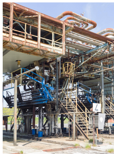
Quais de chargement route multiproduits (Unité 530). Passerelles de chargement en dôme (par le toit), dispositif réservé aux produits lourds (normes de sécurité). Phot. Stéphane Asseline, Phot. Stéphane Asseline IVR11_20237700363NUC4A
