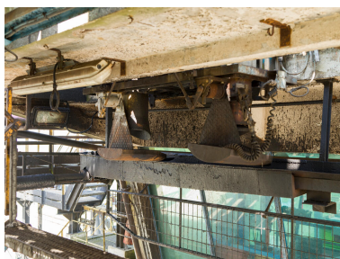
Chargement poste fer (Unité 540). Réceptacle égouttures des deux cannes de chargement. Phot. Stéphane Asseline, Phot. Stéphane Asseline IVR11_20237700371NUC4A
