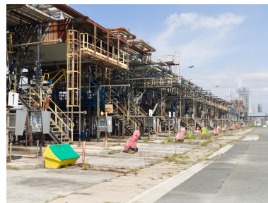
Quais de chargement route multiproduits (Unité 530). Phot. Stéphane Asseline IVR11_20237700360NUC4A
