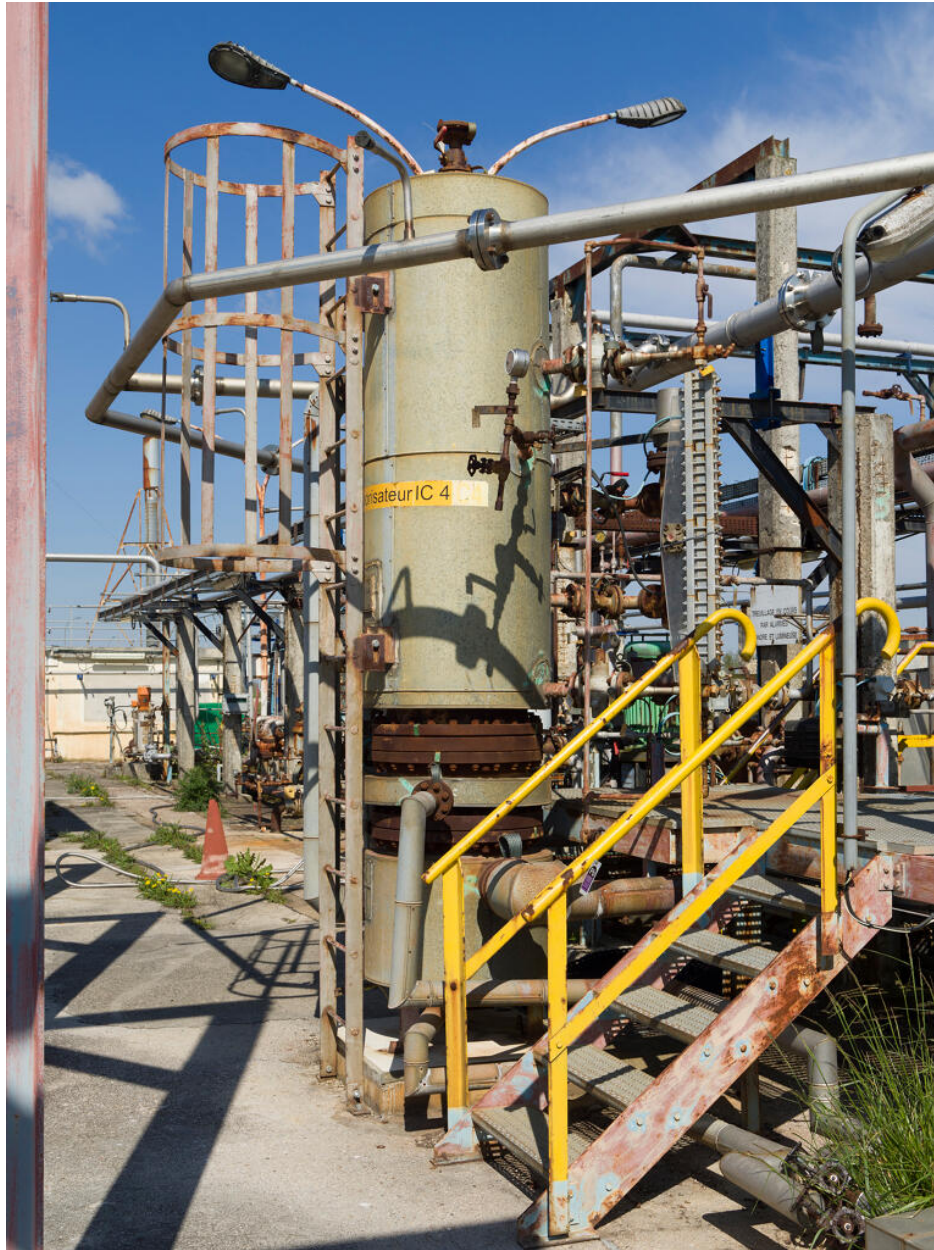
Zone de chargement GPL (Unité 550). Poste de déchargement GPL. Ballon vaporisateur IC4 utilisé lors des déchargements des wagons d'IC4 (isobutane).
