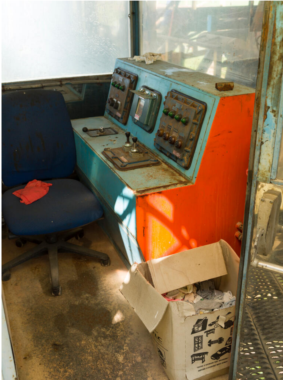
Chargement poste fer (Unité 540). Pupitre extérieur de commande poste fer, permettant le pilotage en direct de la canne de chargement.
