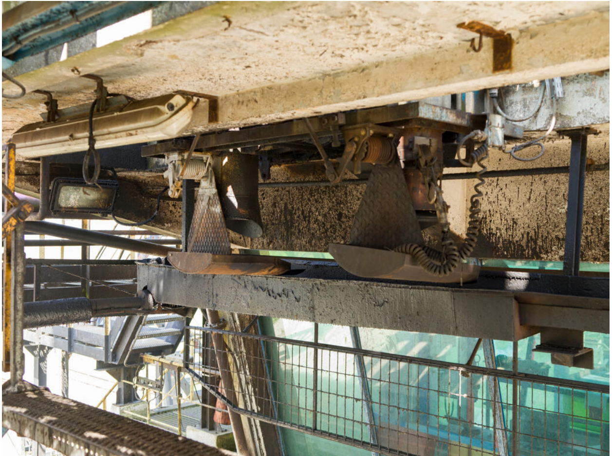
Chargement poste fer (Unité 540). Réceptacle égouttures des deux cannes de chargement.
