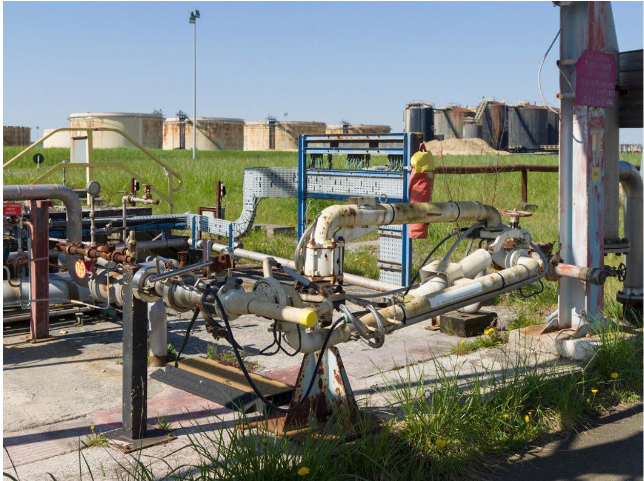
Zone de chargement GPL (Unité 550). Quai de chargement GPL. Bras de chargement GPL.
