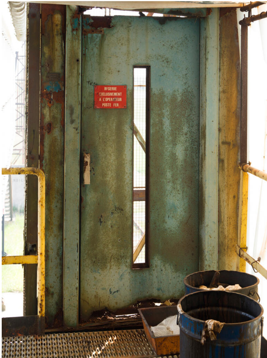
Chargement poste fer (Unité 540). Ancien ascenseur poste fer, inutilisé.
