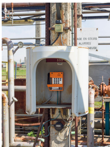
Zone de chargement GPL (Unité 550). Quai de chargement GPL. Généphone ("nouvelle génération") utilisé pour communiquer avec la salle de contrôle sur les opérations en cours, et éventuellement prévenir les secours. Phot. Stéphane Asseline, Phot. Stéphane Asseline IVR11_20237700352NUC4A
