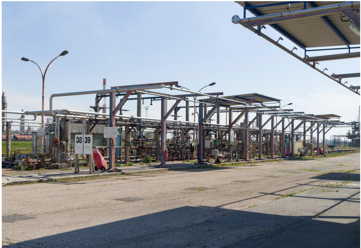
Zone de chargement GPL (Unité 550). Quai de chargement GPL.
