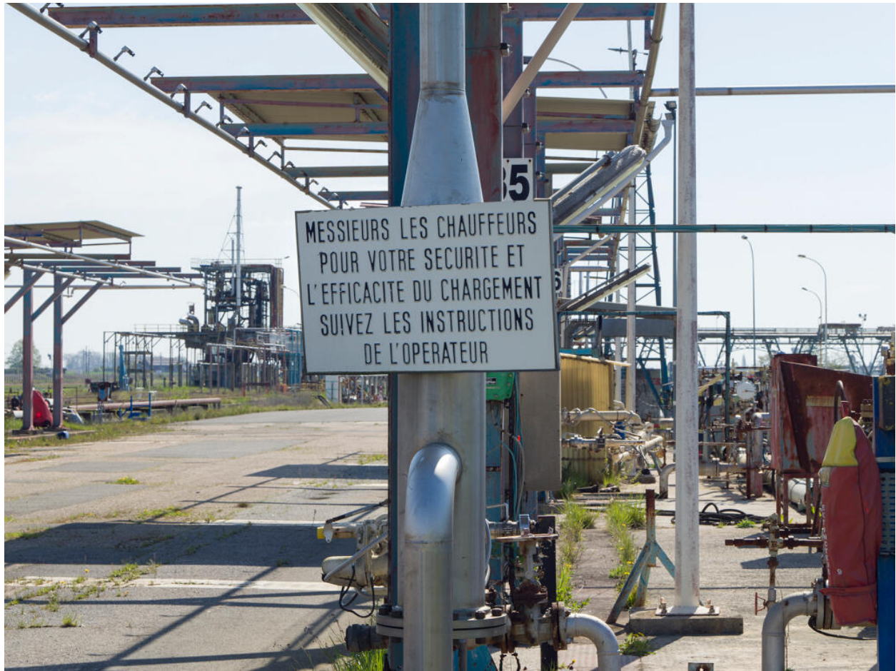
Zone de chargement GPL (Unité 550). Quai de chargement GPL.
