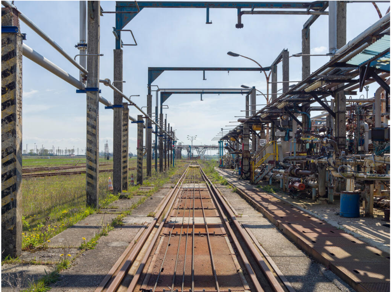
Zone de chargement GPL (Unité 550). Poste de chargement fer GPL.
