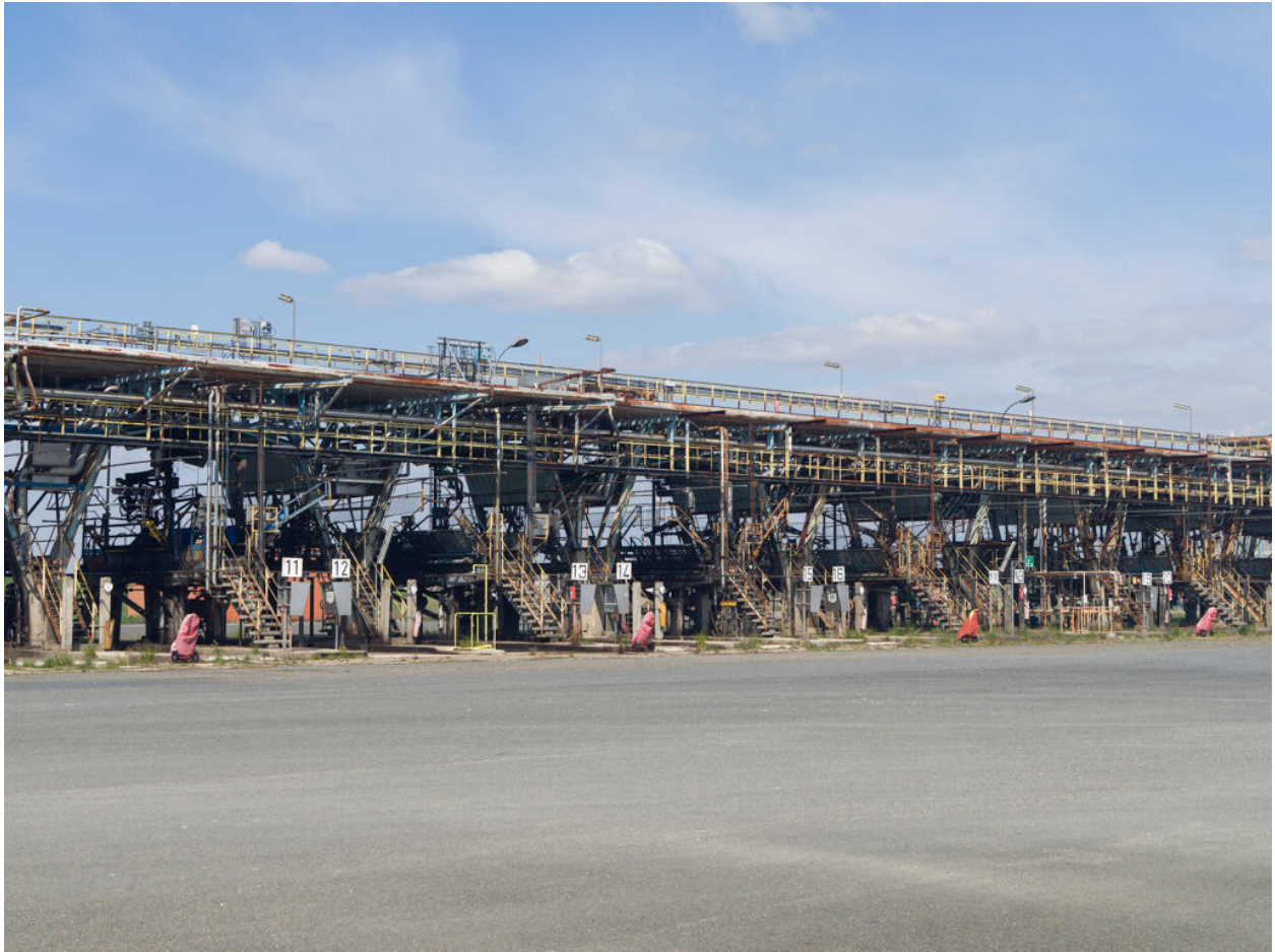
Quais de chargement route multiproduits (Unité 530).
