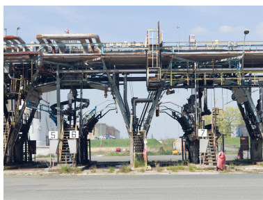
Quais de chargement route multiproduits (Unité 530). Quais de chargement route multiproduits. Le chauffeur est informé en amont du numéro de son quai sur son bon de commande, puis au pont-bascule avec le ticket d'enregistrement (qui indique l'affectation du quai). Phot. Stéphane Asseline, Phot. Stéphane Asseline IVR11_20237700362NUC4A
