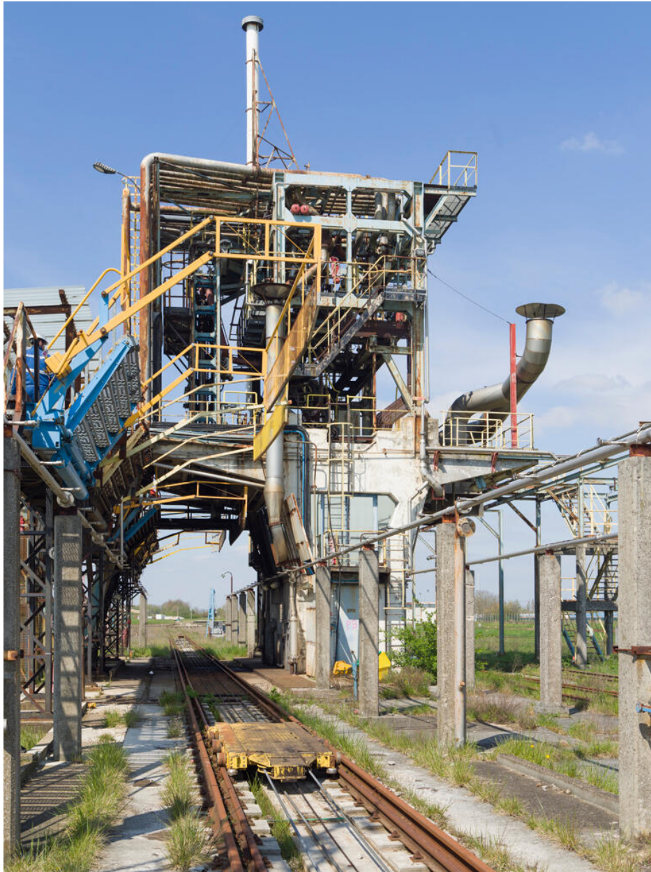
Chargement poste fer (Unité 540). Chargement fiouls lourds, gasoil et FOD (fioul domestique).
