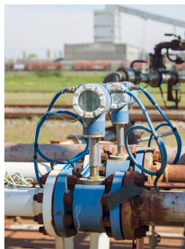
Zone de chargement GPL (Unité 550). Poste de déchargement GPL. Débitmètre. Phot. Stéphane Asseline, Phot. Stéphane Asseline IVR11_20237700354NUC4A
