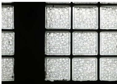
École des Coteaux, bâtiment de 1938, fenêtre du soubassement à pavés de verre Phot. Kruszyk Laurent IVR11_20249200950NUC4A
