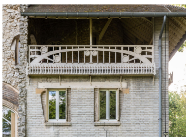
Détail du balcon. Le garde-corps est en bois comme dans les villas balnéaires de Guimard.
