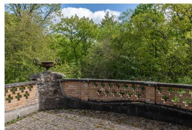
Le balcon de la façade est. La balustrade est en brique et s'élève au-dessus d'une vague en béton. Phot. Kruszyk Laurent IVR11_20249100063NUC4A
