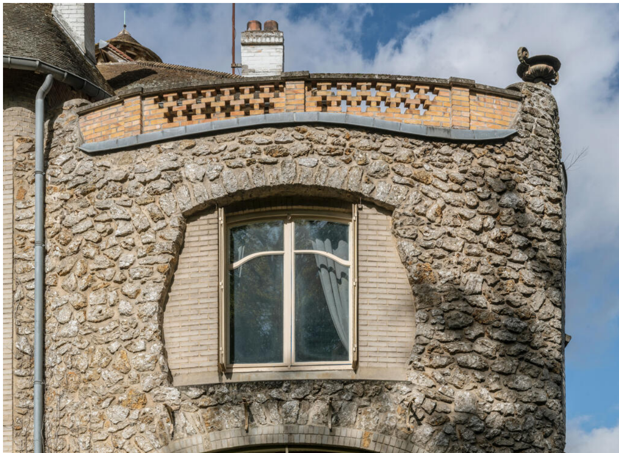
Détail d'une fenêtre et de la balustrade de brique de la façade est.
