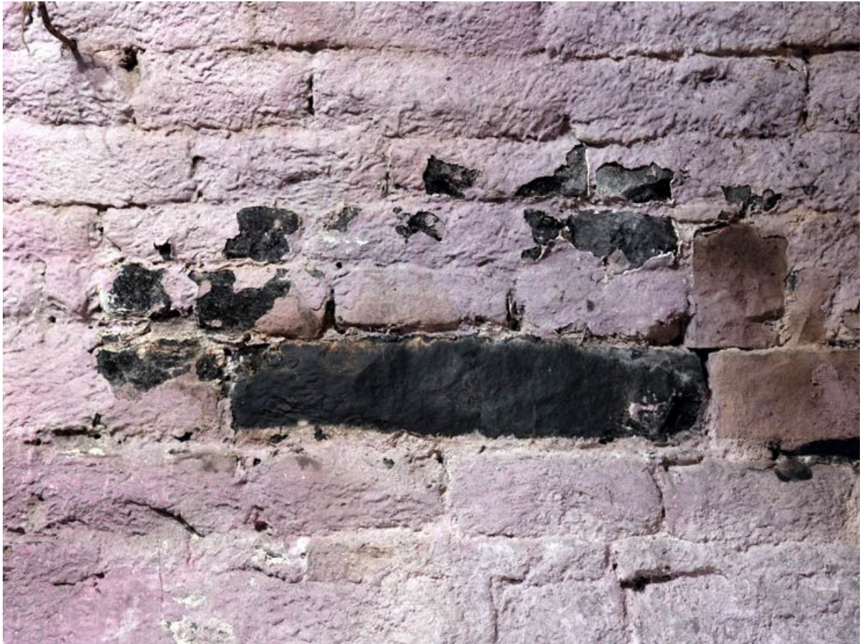
Détail de la maçonnerie, sous l'enduit récent, les moellons de grès sont recouverts de suie.
